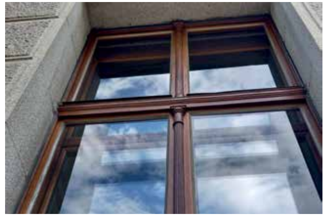
Abb.18: Geringfügig pigmentierter, nicht deckender Ölstrich der restaurierten, historischen Fensterausstattung aus Slawonischer Eiche des Österreichischen Parlamentsgebäudes in Wien.
