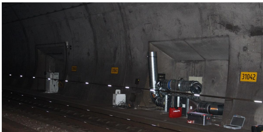
Abbildung 3 Tunnel Münster – Aufbau des Lüftungssystems inklusive den zwei Filterstufen. [13]
