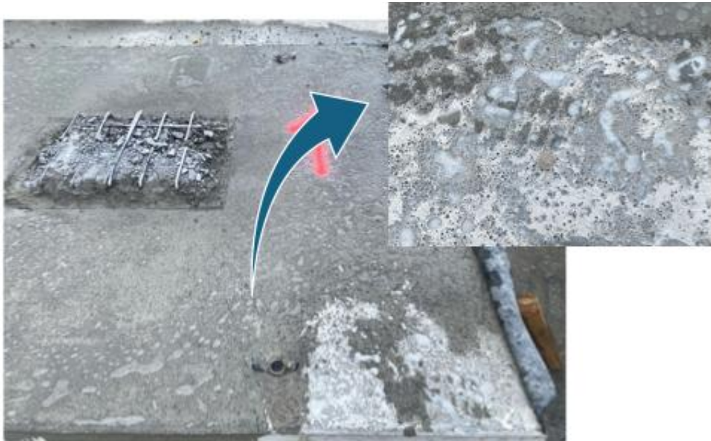
Abbildung 3 Negatives Ergebnis eines Probefeldes mit großen Lufteinschlüssen und Porenbeton
