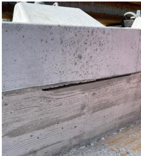
Abbildung 6 Hohlstelle am Rand unter der GTP
