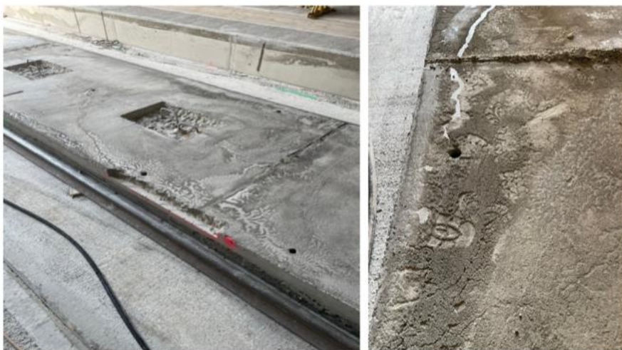
Abbildung 4 Fehlerhafte Vergussbetonoberfläche nach dem Abheben der GTP mit Detailaufnahme mit Schuhabdrücken im weichen schaumartigen Porenbeton
