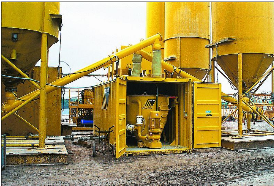
Abbildung 4.11 Mischanlage zur Herstellung der Schmalwandsuspension 117
