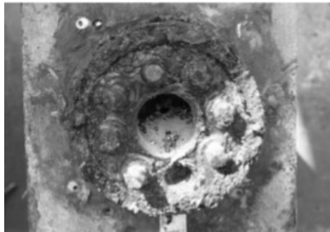
Abb. 13: Oberflächenkorrosion eines Ankerkopfes (Burtscher, Rebhan, Marte, & Scharinger)
