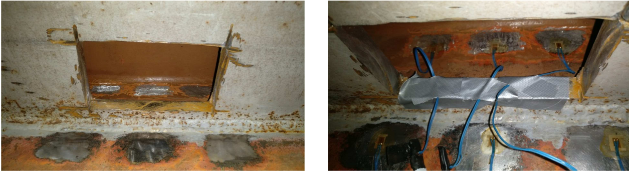
Abbildung 5.2: Öffnung in Verstärkungsblech (links) und Öffnung in Verstärkungsblech mit angebrachten Dehnmessstreifen (rechts) (Foto: Kiem, April 2019)
