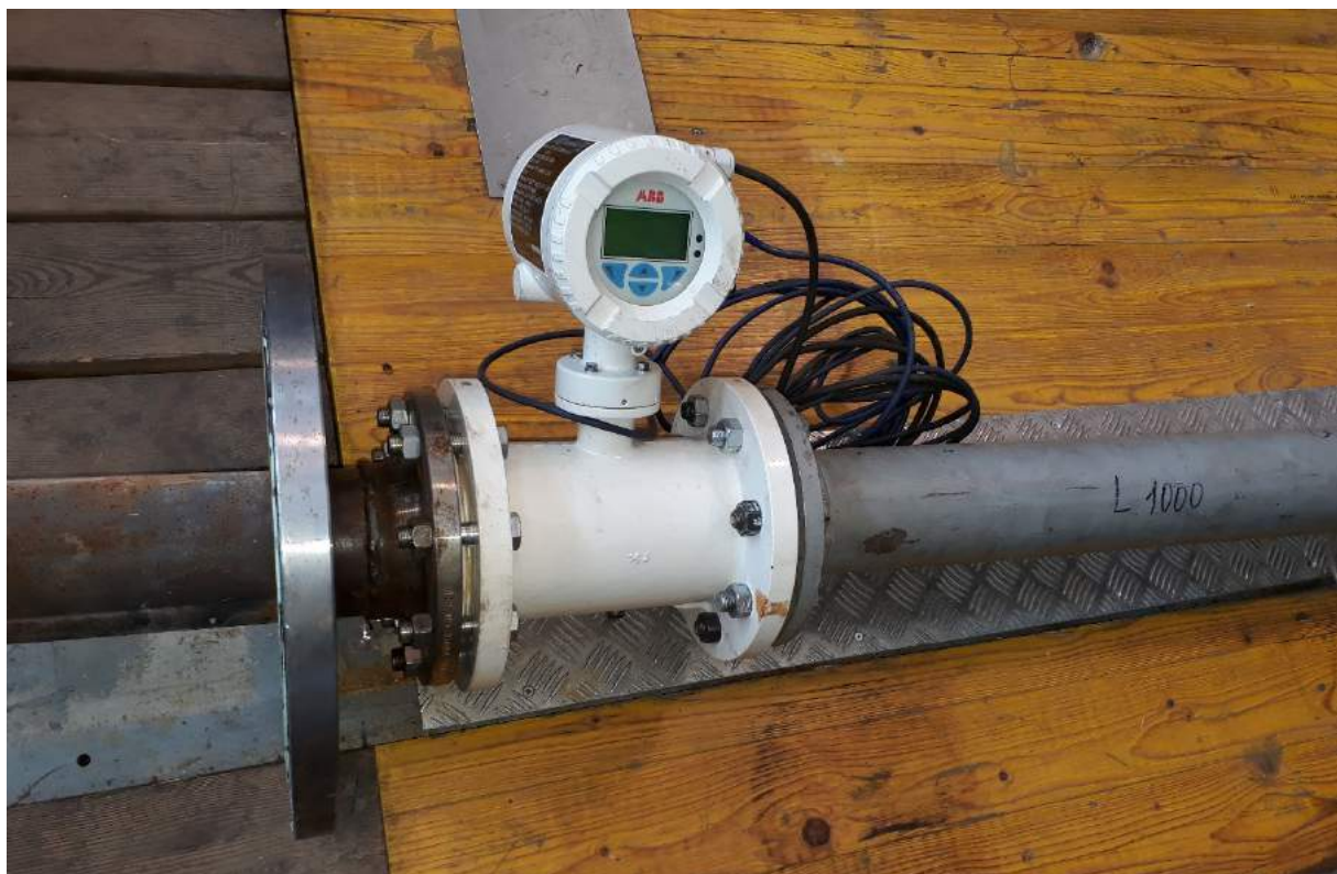
Abbildung 43: IDM 100 in ausgebautem Zustand
