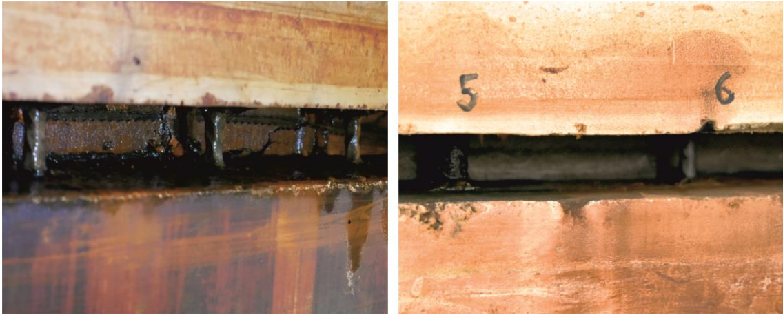
Abb. 111: Beispiel für korrodierte Bewehrung; Links: Gleichmäßig alle Bewehrungselemente; Rechts: Abtrag eines einzelnen Bewehrungselementes
