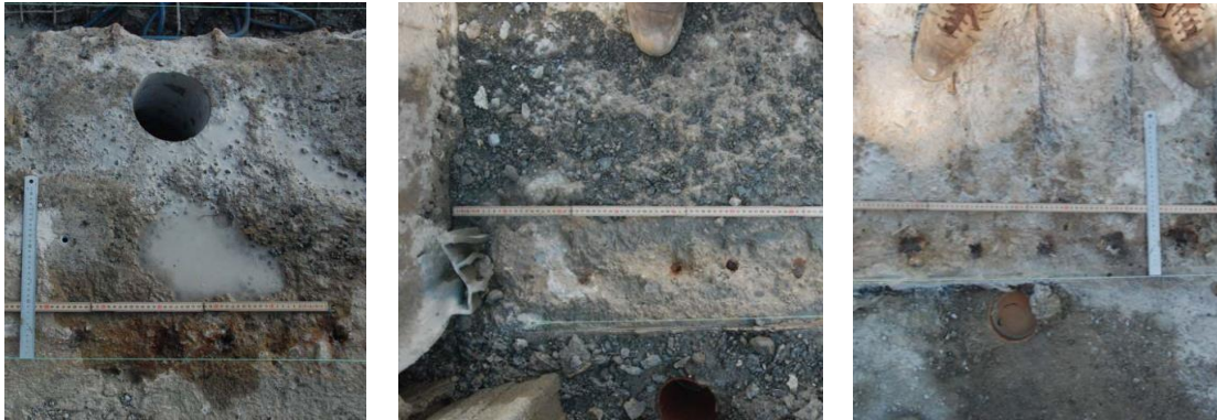
Abb. 44: Anschlussbereich einer versagten Winkelstützmauer; Luftseite im Bild oben
