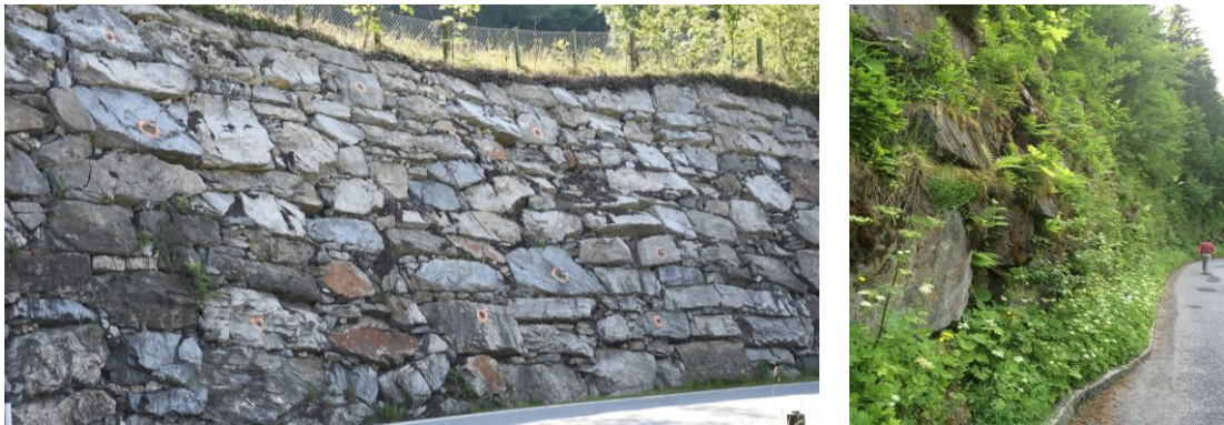
Abb. 27: Schadensbilder bei Steinschlichtkörpern; Links: Ausbauchungen an einer Steinschlichtung; Rechts: Überhang einer stark bewachsenen Steinschlichtung
