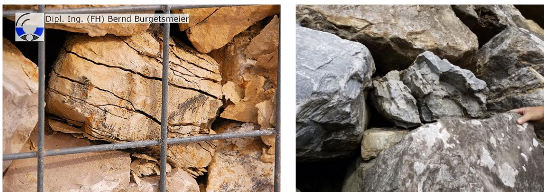
Abb. 26: Schadensbildern bei Steinmauern; Links: Frostschaden an Füllsteinen einer Gabionenwand (Burgetsmeier); Rechts: Überbeanspruchter Füllkörper zufolge einer unzureichenden Zwickelverfüllung eines Steinstützkörpers
