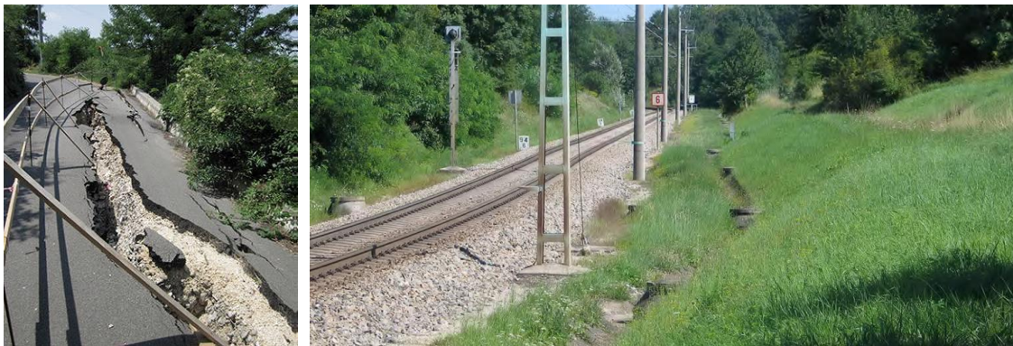
Abb. 31: Links: Abrisskante im Asphalt zufolge eines Böschungsbruches hinter einem Stützbauwerk ( Dialer, 2016 ); Rechts: Versatz von Bahngleisen und der Entwässerungseinrichtung zufolge einer Massenbewegung ( Leopold, 2012 )
