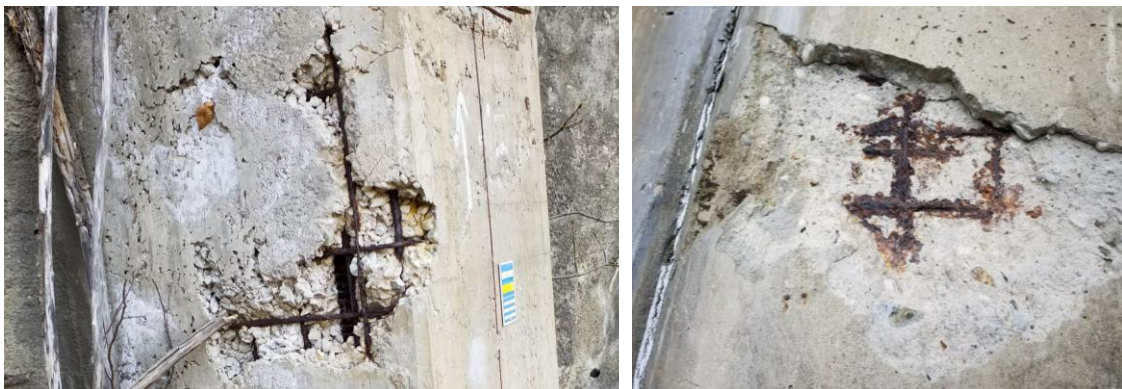
Abb. 35: Links: Kiesnest mit freiliegender Bewehrung; Mitte: Betonabplatzung an der Vorderseite eines Stützbauwerkes
