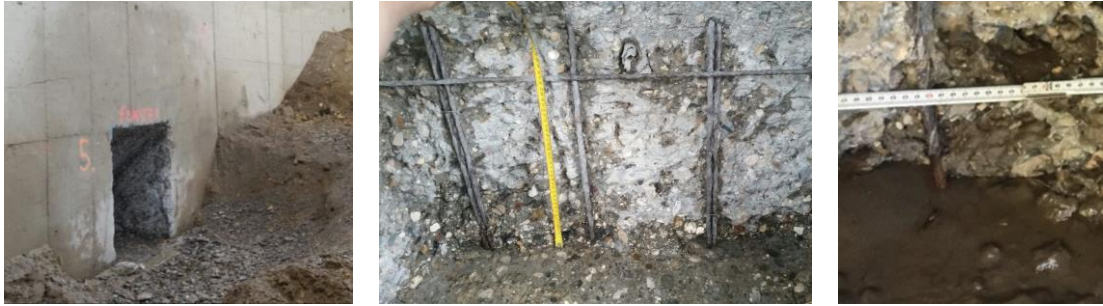
Abb. 22: Links: HDW-Fenster an einer Stützmauer; Mitte: freigelegte Bewehrung an der Hinterseite; Rechts: Korrosionsstelle im Bereich der Arbeitsfuge
