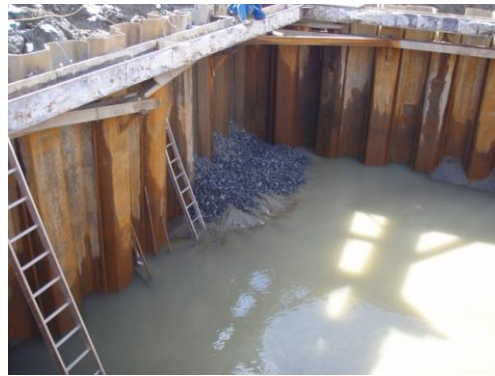
Abb. 32: Hydraulischer Grundbruch bei einer Baugrubenumschließung (Marte, 2018)
