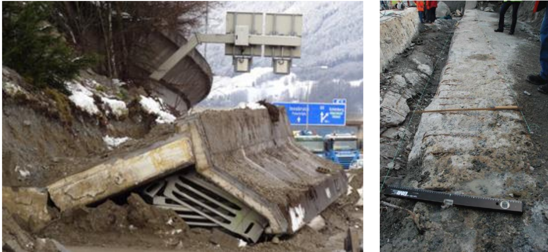
Abb. 1: Links: Versagen einer Spornmauer an der Brennerautobahn; Rechts: Zustand der Arbeitsfuge nach dem Verbruch der Wand (ASFINAG)
