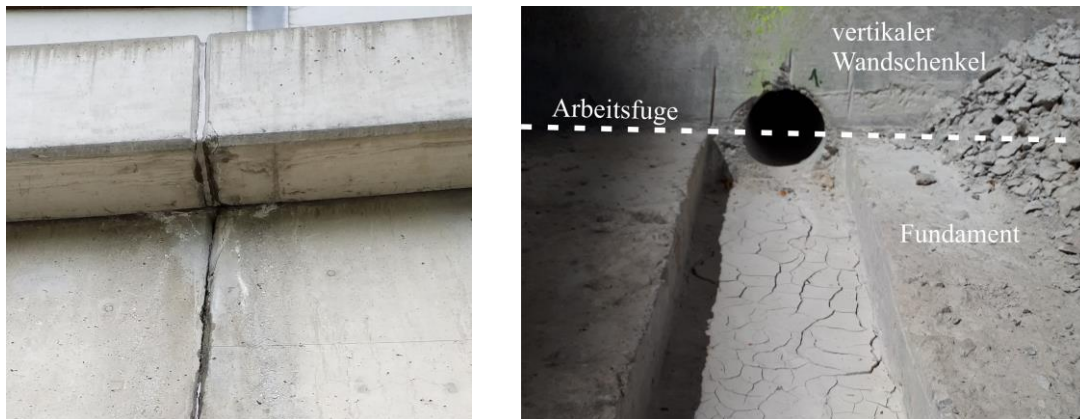
Abb. 37: Links: Bauteilfuge einer Winkelstützmauer; Rechts: Arbeitsfuge einer Winkelstützmauer in welcher eine Sondierbohrung durchgeführt wurde
