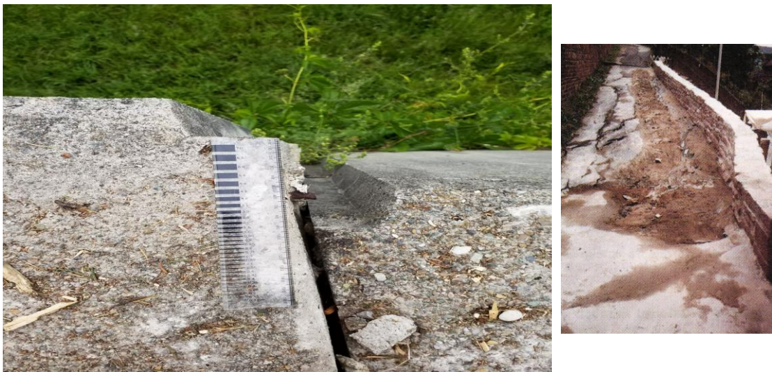
Abb. 30: Links: Verkippung eines Blockes einer Winkelstützmauer; Rechts: Risse und Absackungen im Hinterfüllungskörper (Schwing, 1991)
