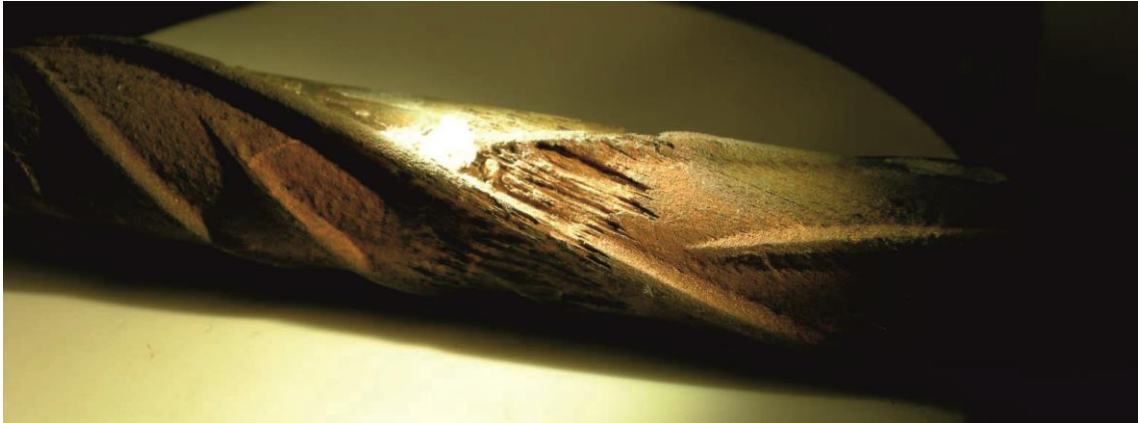
Abb. 47: Korrosionsabtrag an einem Bewehrungsstabeisen (entnommen aus Abb. 41 Rechts) im Bereich der Arbeitsfuge
