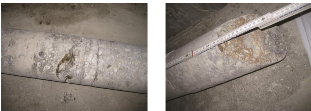
Abb. 43: Links: Ansicht einer Arbeitsfuge durch eine Kernbohrung; Rechts: Verschmutzte Kontaktfläche einer Arbeitsfuge (ASFINAG)
