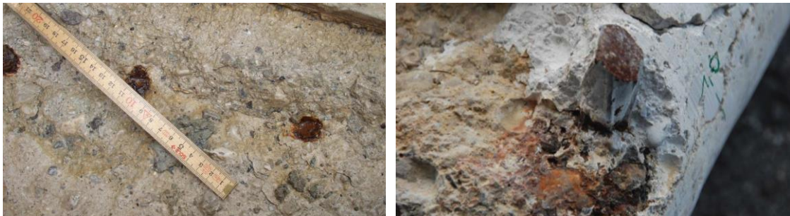
Abb. 45: Links: Anschlussbewehrung einer versagten Winkelstützmauer (Erdseite im Bild oben); Rechts: Korrodierte Bewehrung im Bereich der Arbeitsfuge
