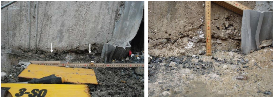
Abb. 39: Links: Ansicht des Querschnittes einer Winkelstützmauer im Bereich der Arbeitsfuge; Rechts: Detailansicht mit Kiesnest und klaffender Fuge ( ASFINAG )
