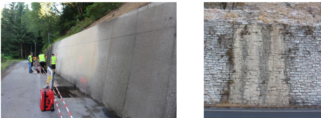
Abb. 19: Links: Witterungsbedingte Schäden an der Bauwerksoberfläche, Auswaschungen an der Oberfläche einer Betonwand; Rechts: Schadhafte Entwässerung
