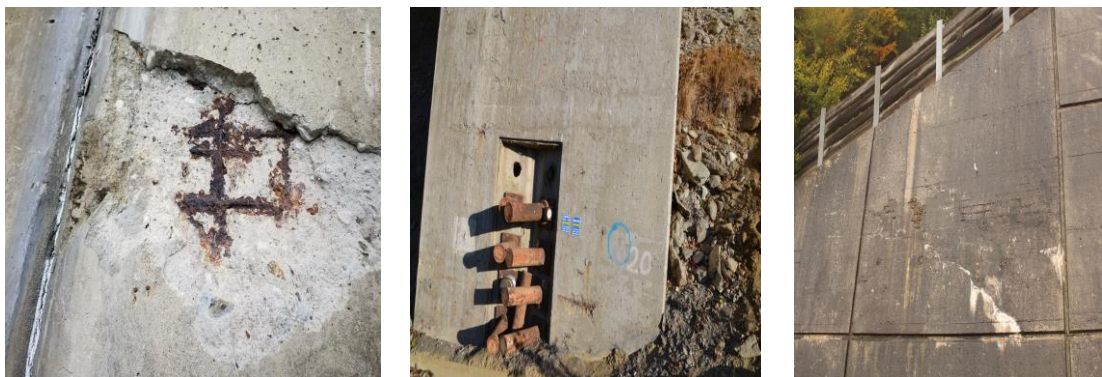
Abb. 25: Beispiele für oberflächliche Schäden an Betonbauwerken
