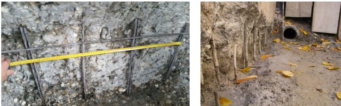
Abb. 48: Links: Freigelegte Bewehrung einer Gewichtskonstruktion; Rechts: Durch Ausgrabung freigelegte Anschlussbewehrung (GUMA, 2014)
