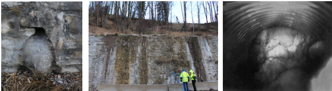
Abb. 28: Beispiele für eine unzureichende Entwässerung; Links: Schadhafte und bereits vereiste Entwässerungseinrichtung; Mitte: Überströme Gewichtsmauer zufolge einer nicht funktionstüchtigen Oberflächenentwässerung; Rechts: Verschluss eines Drainagerohres ( Muth , 1997)
