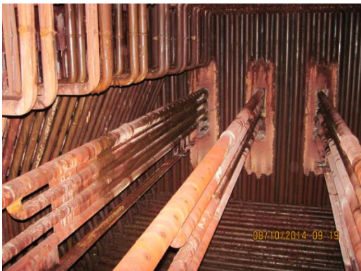
Abbildung 127 - NH 3 -Eindüseverrohrung Kessel innen (3 Lanzen)
