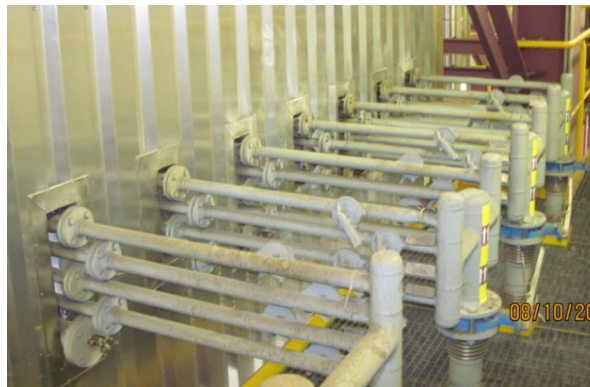
Abbildung 128 - NH 3 -Eindüseverrohrung Kessel außen (7 Lanzen, halber Kessel)
