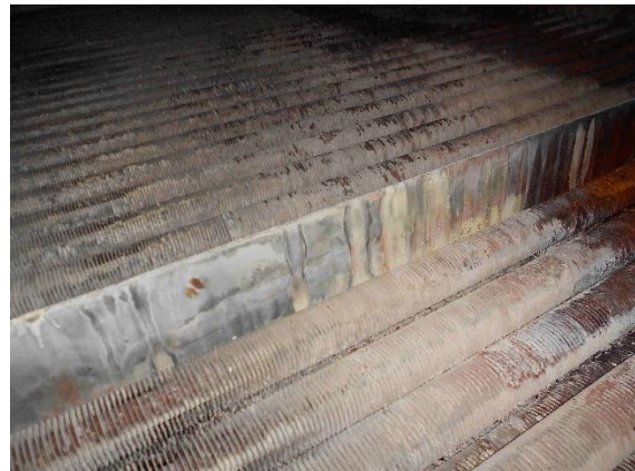
Abbildung 102 – Kondensatvorwärmerschleife und Economiserheizfläche
