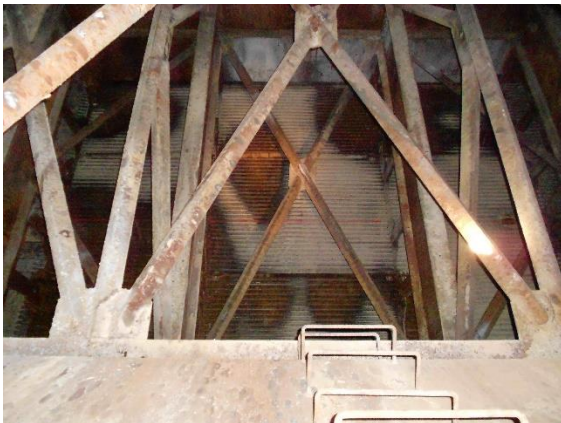
Abbildung 101 - Blick auf Fernwärmeschleife
