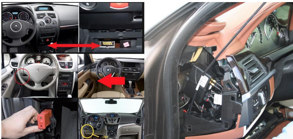
Abbildung 56: Einbausituation links: OBDII Dongle, rechts: CAN Box
