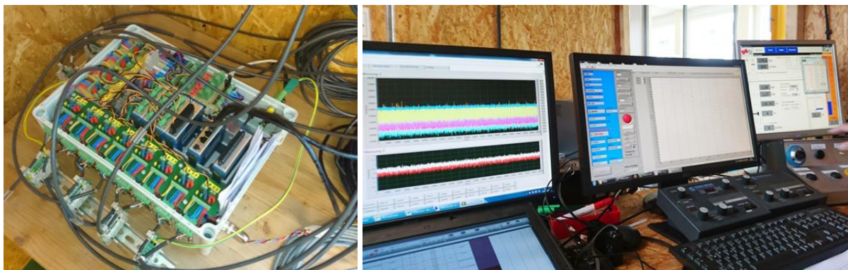
Abb. 3-13: Messsystem zur Datenakquirierung und Messplatz
