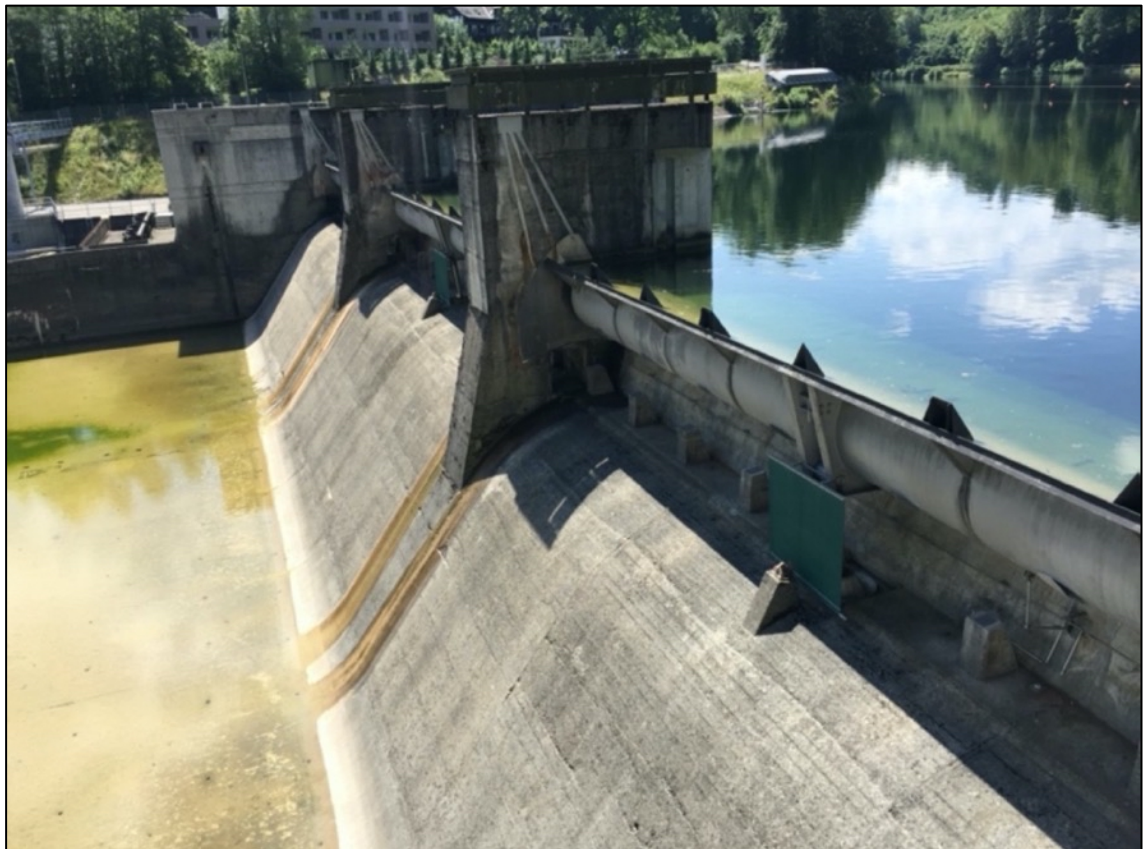
Abb. 22: Flusskraftwerk Gmunden, eigene Aufnahme
