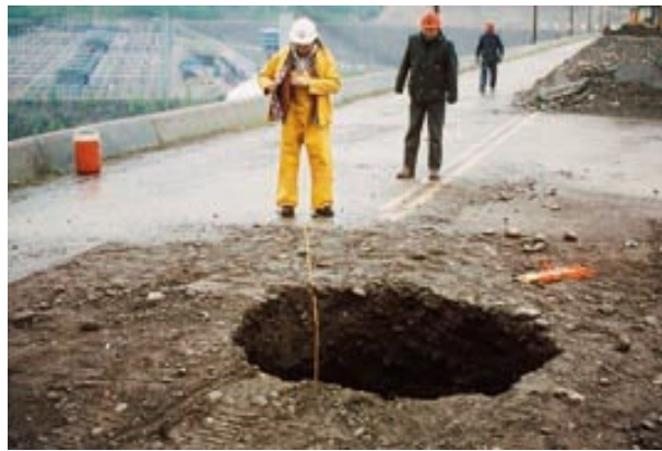
Abbildung 6.26: Bennett Damm: Sinkhole [46]
