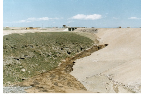
(b) 11:20 Uhr: Fortschreiten der Erosion in Richtung Dammkrone
