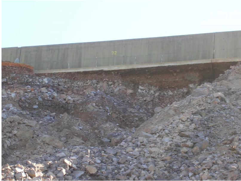
Abbildung 6.7: Unterspülung des Fundaments der Betonmauer [33]
