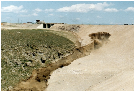
(c) 11:30 Uhr: Fortschreiten der Erosion in Richtung Dammkrone
