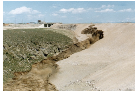
(d) 11:35 Uhr: Fortschreiten der Erosion in Richtung Dammkrone
