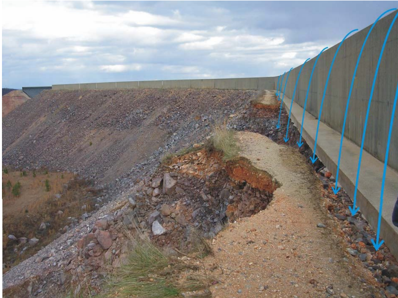
Abbildung 6.8: Erosion der Dammkrone und Unterspülung v. Fundament [33]
