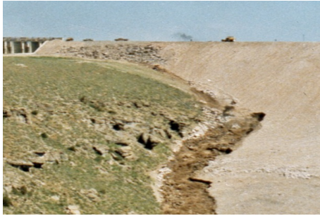
(a) 11:00 Uhr: Austritt von trübem Wasser verursacht Erosion des Dammes. Bulldozer auf der Dammkrone
