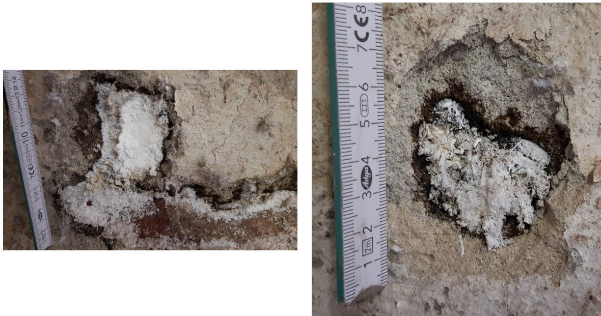
Abbildung 47 Salzausblühungen im Untergeschoß des Forschungsgebäudes
