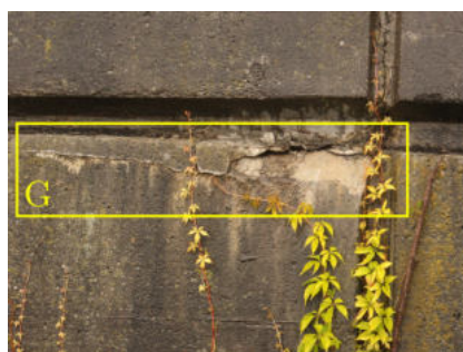
(d) G Frostschaden durch Bewehrungskorrosion
