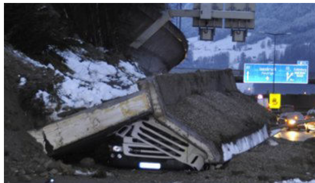
Abbildung 1-1: Schadensbild des Wandverbruchs 1
