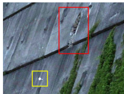
(b) Nicht erkannte Schadstelle (rot)
