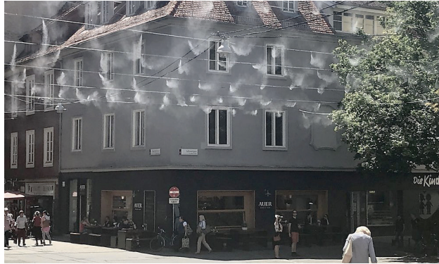
Abb. 4.7 Sprühnebelanlage - Tummelplatz Graz
