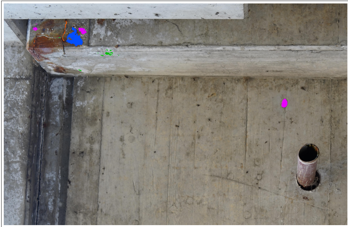
Abbildung 4.31: Die drei Abplatzungen (Magenta), die Korrosion (Blau) und der Riss (Orange) werden in der XML-Datei als Klassen segmentiert. Die Aussinterung (Grün) und ein Riss (Orange) wurden aufgrund der Gewichtung und kleinen Fläche nicht segmentiert.
