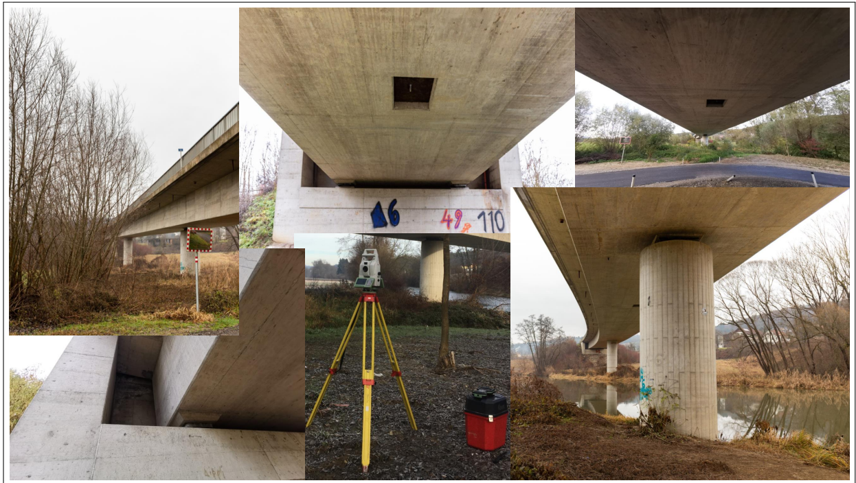
Abbildung 5.1: Optimale Aufnahmebereiche für die terrestrische Multistation (Leica Nova MS60) bei dem Referenzobjekt.
