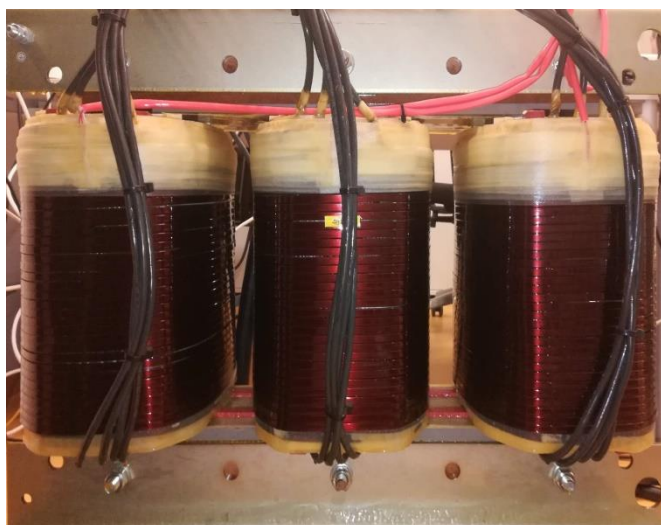
Abbildung 34 Transformator der als Drossel verwendet wurde
