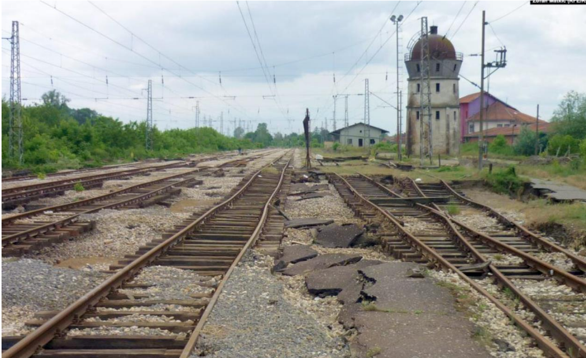
Abb. 52: Freilegung der Leitschienen im Bahnhof Samac nach einer Sturzflut [Q52]
