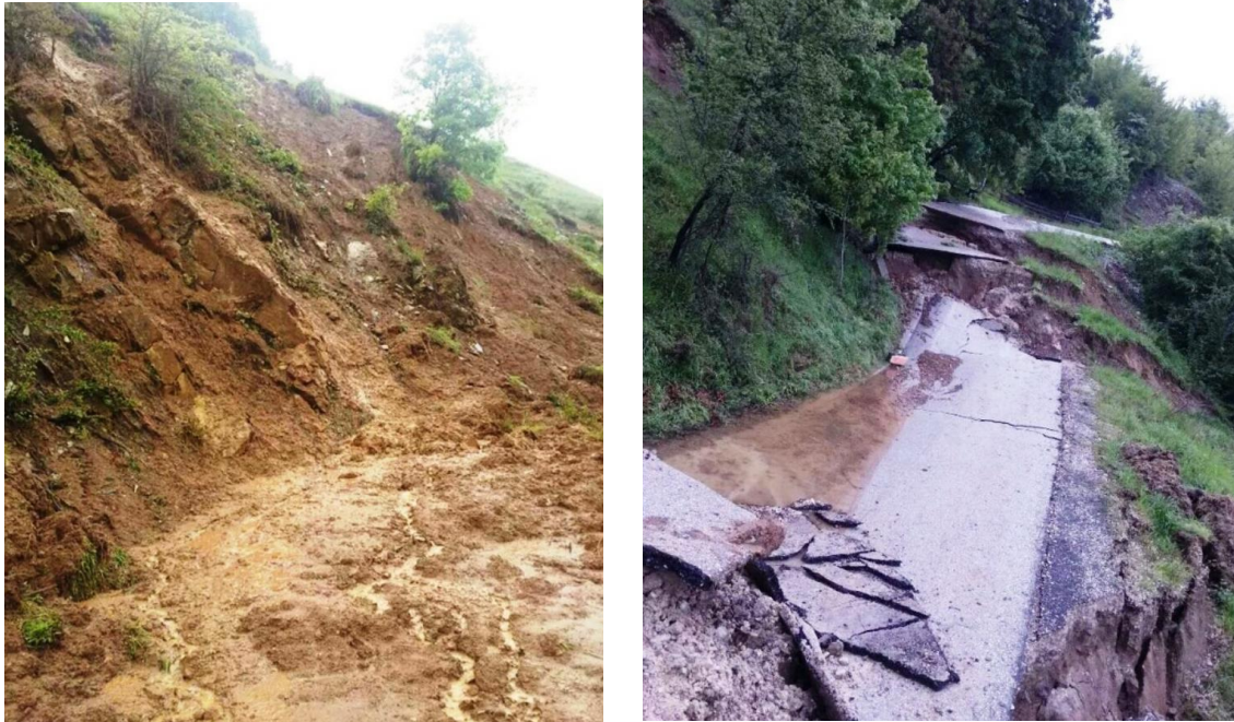
Abb. 51: Blockierte bzw. zerstörte Straßen aufgrund von Rutschungen [Q51]
