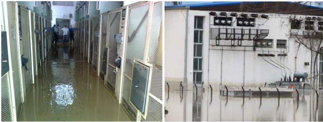
Abb. 46: Schäden an Übertragungsleitungen und Versorgungsanlagen nach der Überschwemmung 2014 [Q46]
