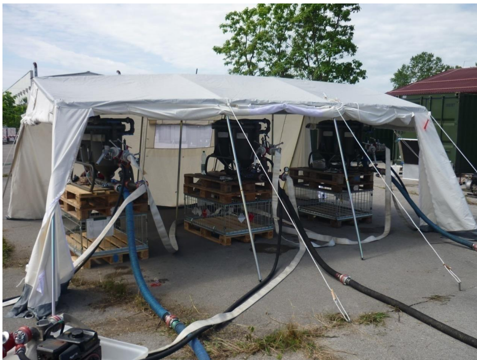
Abb. 66: Chemische Wasseraufbereitung mit TWA 6 [Q66]
