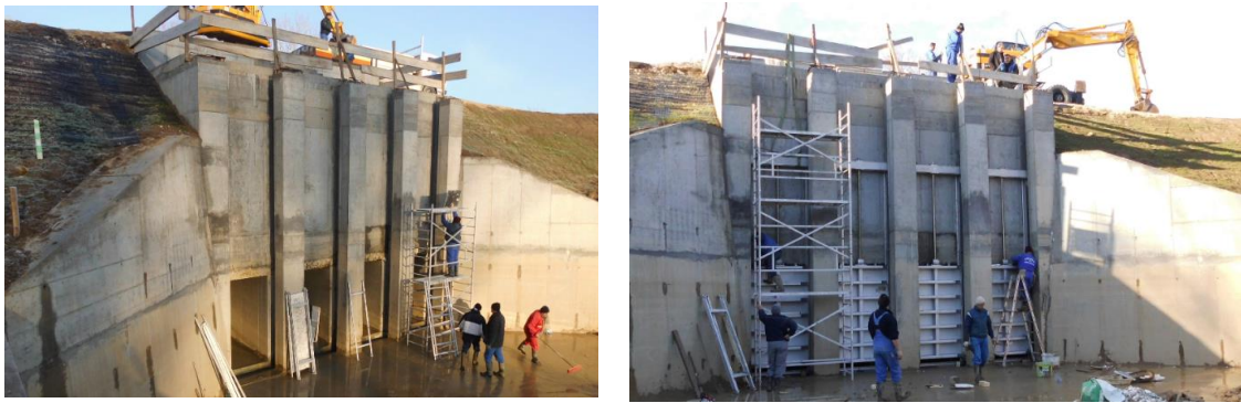
Abb. 88: Rechts: Installation der Verschlussorgane in Vučilovac Brčko [Q89]
