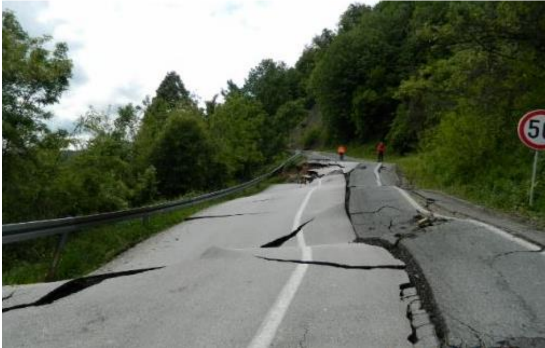
Abb. 50: Schwer beschädigte Landstraße nahe Tuzla [Q50]
