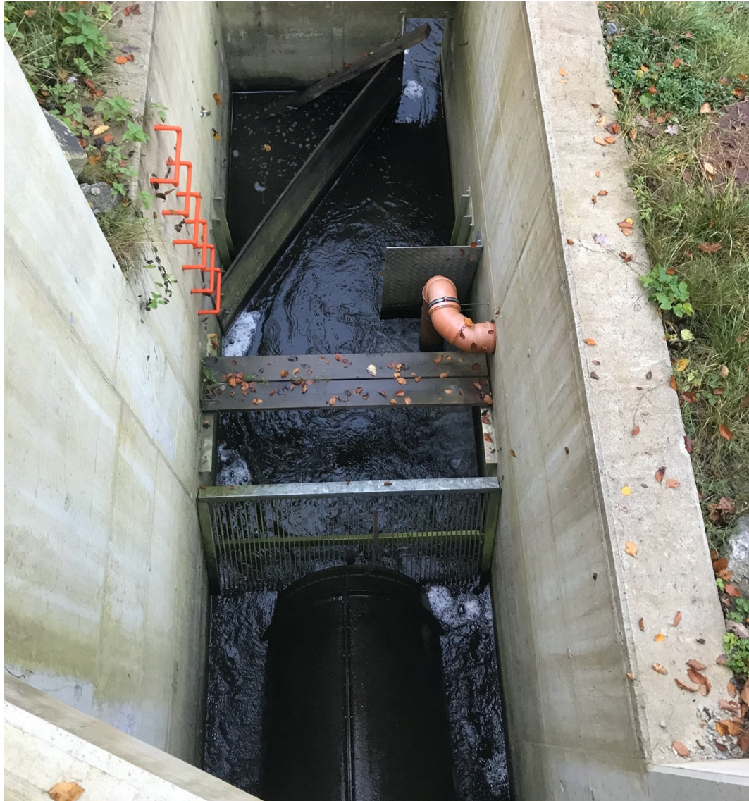
Abbildung 12: Einstieg einer FAS an der Feistritz mit zusätzlicher Leitstromdotation (KG-Rohr) (eigene Aufnahme)
