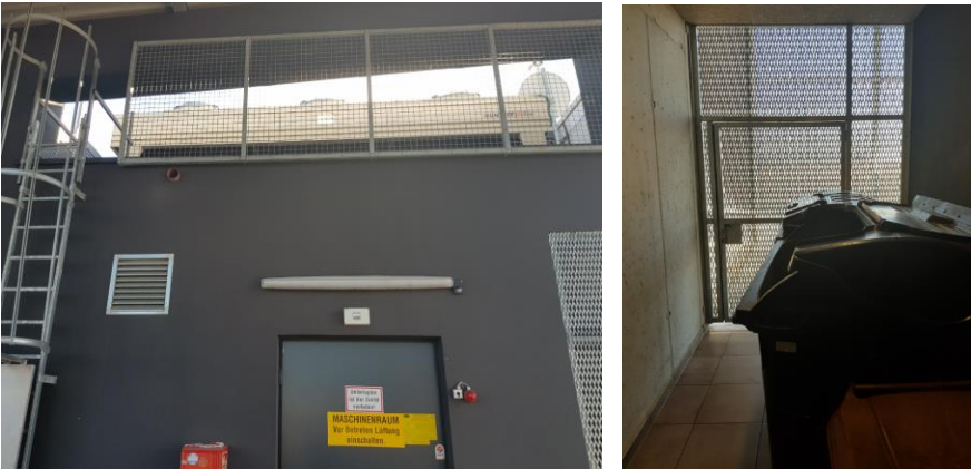
Abbildung 2.40: Links: Aufstellflächen der Kondensatoren auf dem Dach; rechts: der Eingang zum Müllraum
