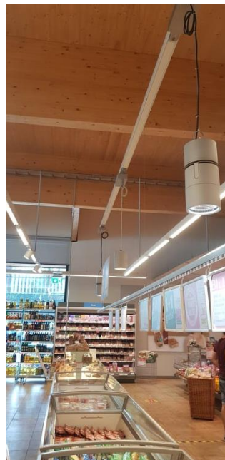
Abbildung 2.12: Beleuchtung in FK-Bereich
