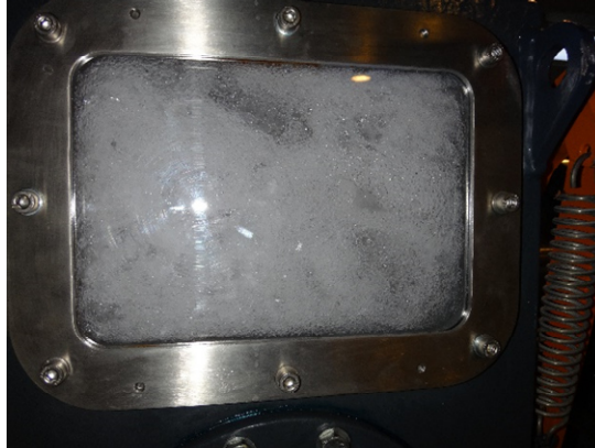
Abbildung 2-18: Hosenrohrseitiges Fenster war im Betrieb vollkommen mit Spritzwasser benetzt.
