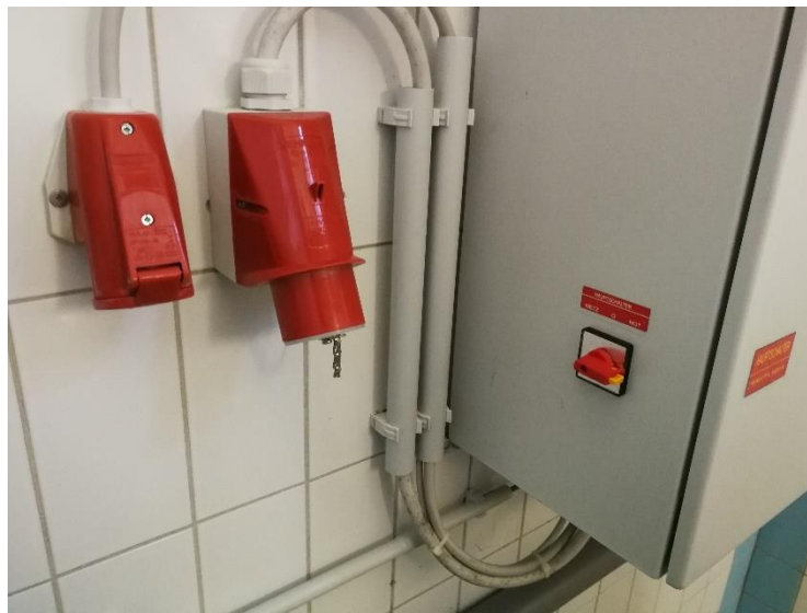
Bild 5.9: Notstromspeisung Hochbehälter Eichkögl
