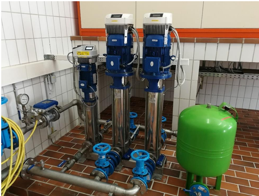
Bild 5.5: Drucksteigerungspumpen Mitterfladnitz (links 3 kW, mittig und rechts 7,5 kW)
