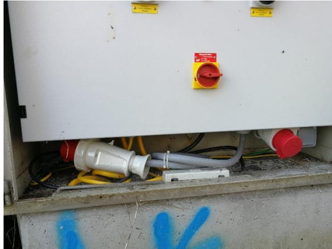
Bild 6.5: Netztrennschalter mit Möglichkeit zur Notstromeinspeisung
