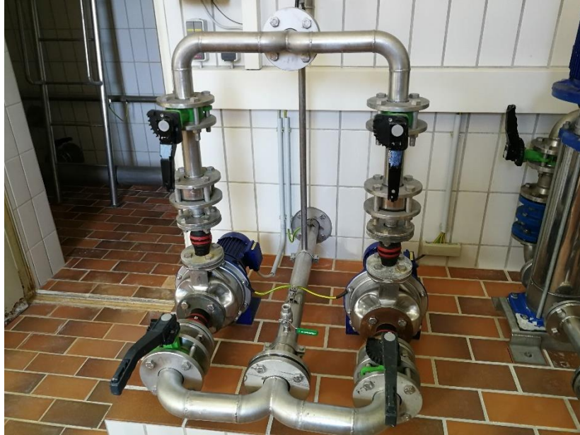
Bild 5.4: Rückspülpumpen zur Reinigung der Filterstufen
