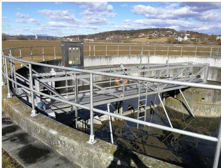
Bild 6.9: Nachklärbecken mit Abzugeinrichtung an der Wasseroberfläche
