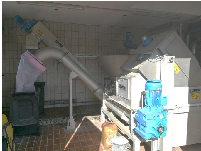
Bild 6.6: Rechenraum der Kläranlage
