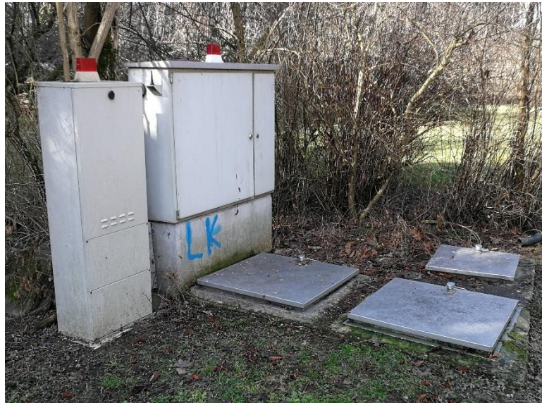
Bild 6.4: Pumpstation Fladnitz; Schaltschränke: rechts - Pumpstation, links - Schacht Fladnitz Siedlung
