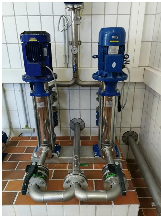
Bild 5.6: Pumpen zur Füllung des Hochbehälters in Eichkögl
