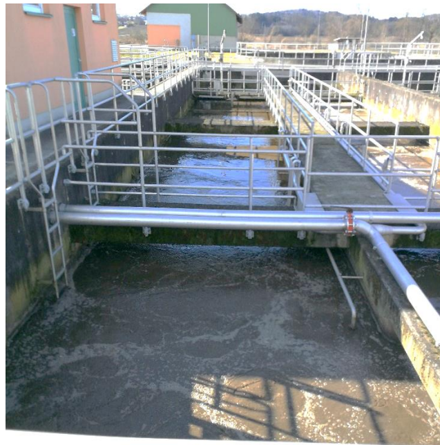
Bild 6.8: Belebungsbecken mit brodelnder Wasseroberfläche
