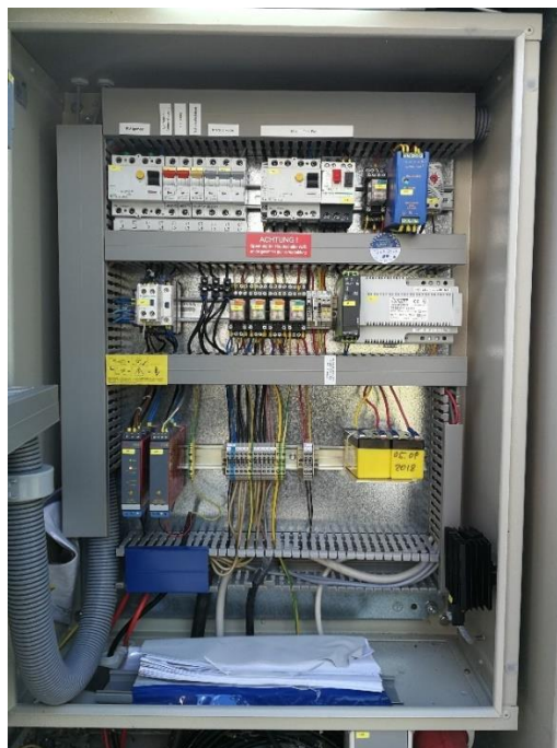
Bild 6.2: Pumpstation Eichkögl Hausnummer 40 - Schaltungsaufbau im Inneren
