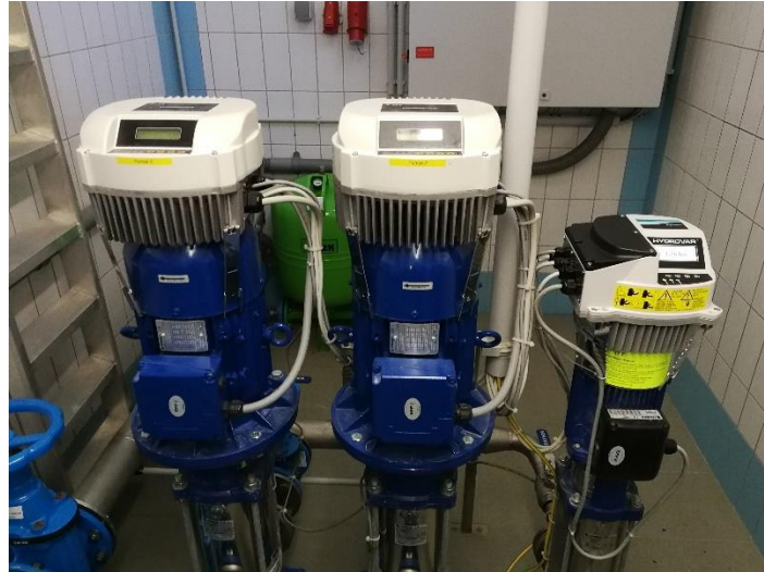
Bild 5.7: Drucksteigerungspumpen Eichkögl (links und mittig 5,5 kW, rechts 1,5 kW)
