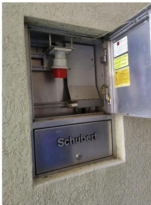
Bild 5.8: Noteinspeisung Pumpstation Mitterfladnitz
