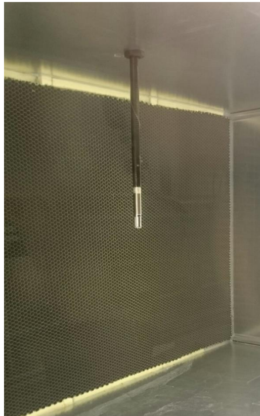
Abbildung 4-18: Einbausituation des Feuchtesensors am ExHX-Eintritt
