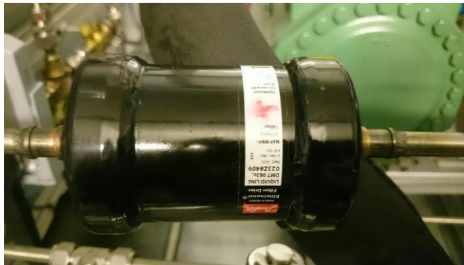
Abbildung 4-16: Filtertrockner im eingebauten Zustand
