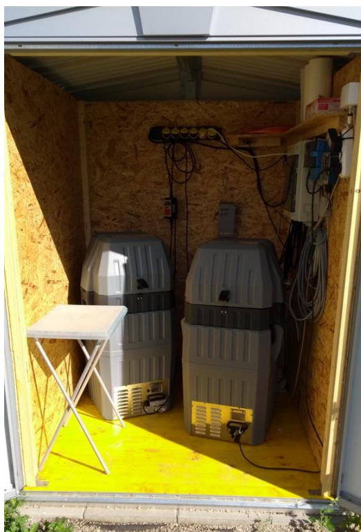
Abbildung 2-19: Errichtete Messhütte mit den Probenahmegeräten an der MS-Mischwasser
