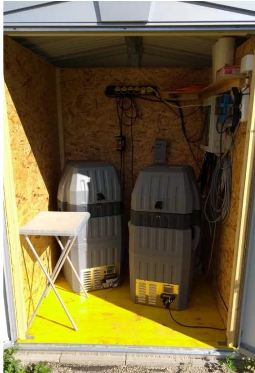
Abbildung 3: Errichtete Messhütte mit den Probenahmegeräten an der MS-Mischwasser
