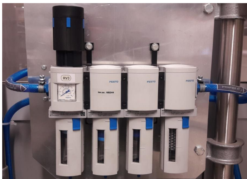
Abbildung 29: Vierstufige Luftaufbereitungseinheit – Kombination aus Filterregelventil, Fein-, Feinst- und Aktivkohlefilter (von links nach rechts)
