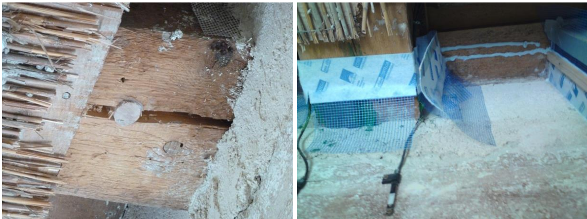
Bild 18 Links ein Dübel zum Verschließen der Längsrisse und der durch Putzmörtel geschlossene Luftspalt; rechts Abkleben der Kanten zwischen Balken und Einlegeböden zur Wandoberfläche mit Putzanschlussklebeband
