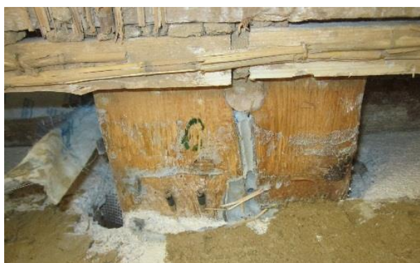
Bild 33 Auflager 5 nach Entfernen von Dämmung und Dichtband: Holzdübel und Korkfüllmasse kommen zum Vorschein
