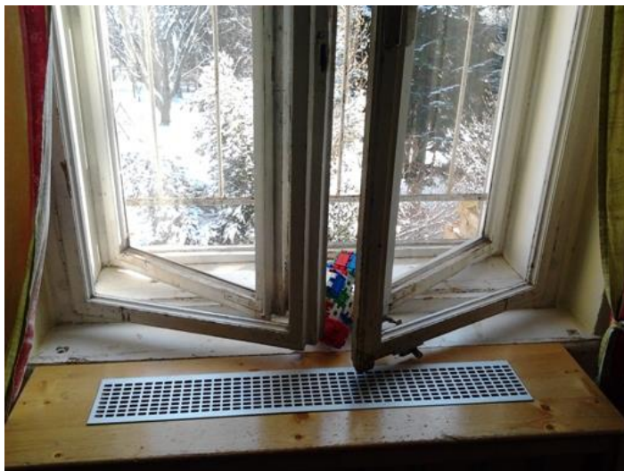
Bild 56 Eine Figur aus Bausteinen verhindert das Schließen der Fensterflügel im OG-Zimmer
