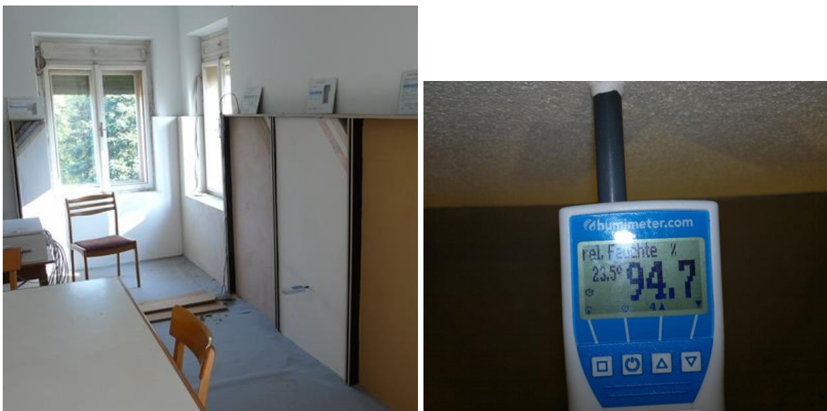
Bild 61 Handgerät mit kombiniertem Temperatur-/Luftfeuchtesensor misst im mit Wärmedämmputz gedämmten Feld die Verhältnisse auf der ehemaligen Bestandsoberfläche
