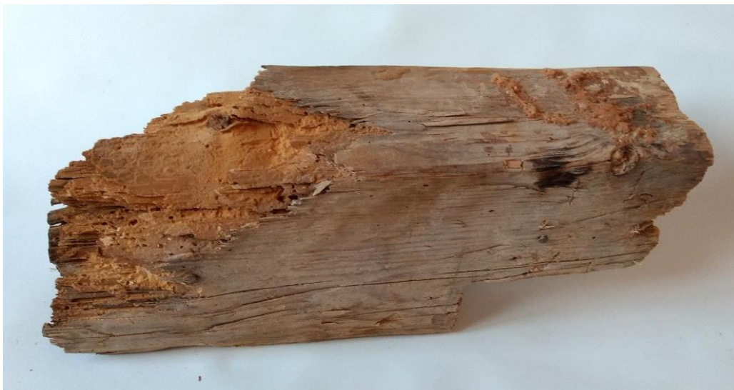
Bild 4 Balkenkopf mit Schadensbild, das an der oberen Außenecke deutlich ausgeprägter ist
