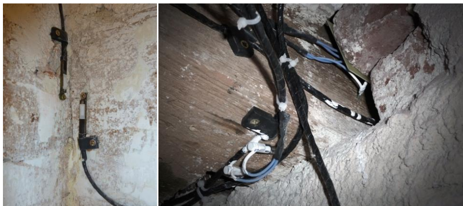
Bild 15 Links kombinierte Luftfeuchte-/Temperatursensoren in der Gebäude-Außenkante; rechts diverse Holzfeuchtesensoren an Balken 1
