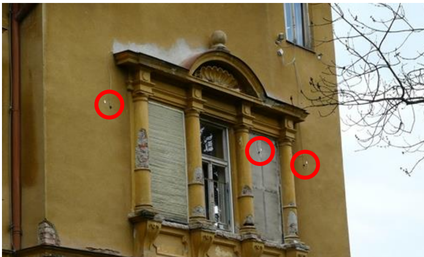
Bild 79 Positionen der Oberflächentempersensoren auf der nach Südwestsüd ausgerichteten Außenwand
