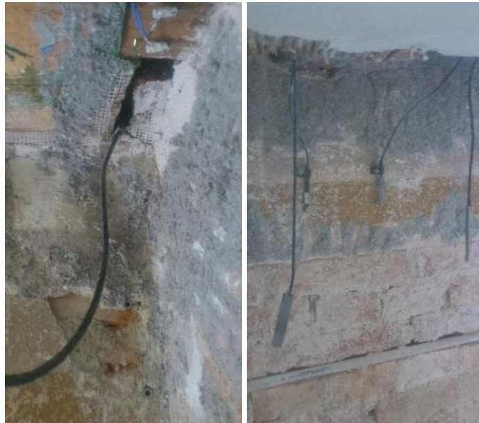
Bild 34 Auflager 2: links das Kabel eines Auflagersensors; rechts herunterhängende Kabel weiterer Auflagersensoren
