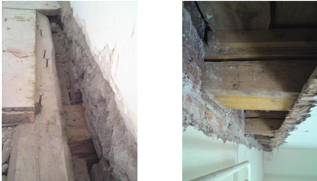
Bild 11 Links Deckenöffnung im Dachgeschoßzimmer und rechts im Obergeschoß
