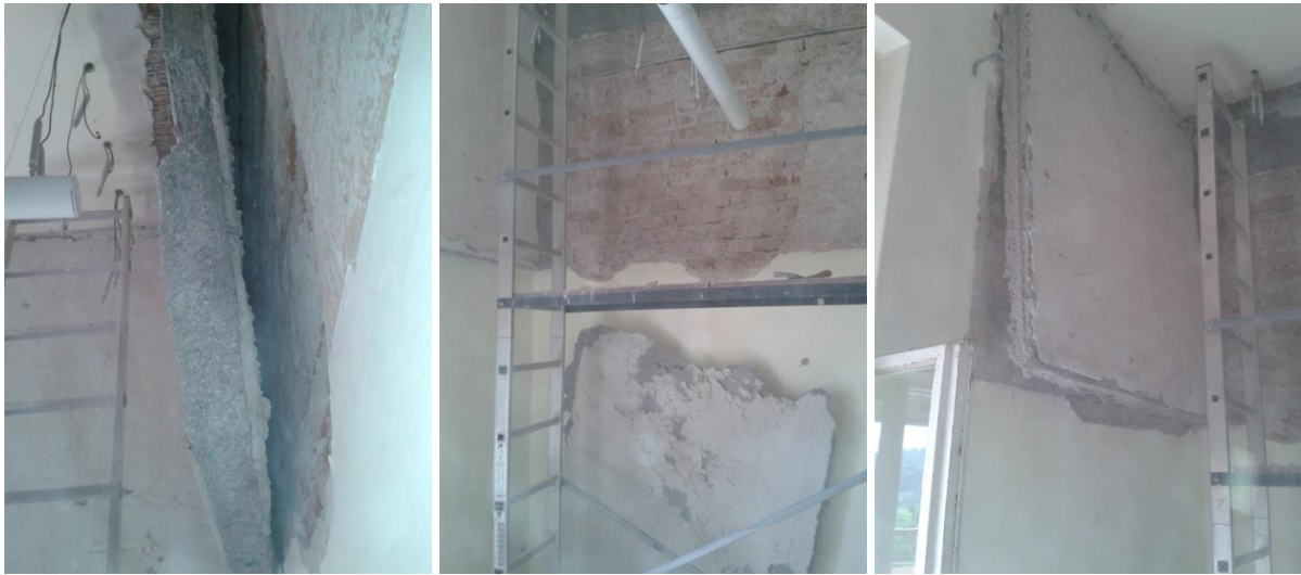
Bild 27 Abbruch Zellulosedämmung: Dämmung löste sich großflächig mit Teilen des Bestandputzes
