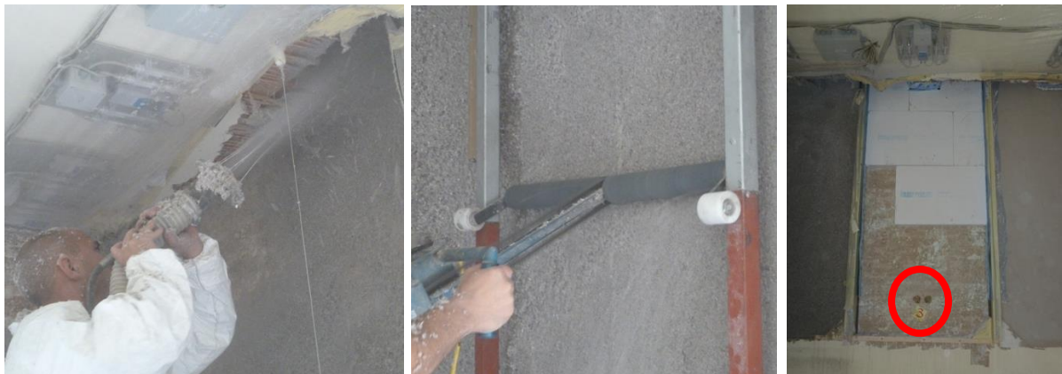
Bild 19 Links Aufspritzen der Zellulosedämmung in Feld 1; in der Mitte Abziehen auf die gewünschte Schichtdicke mit Führungsschienen; rechts die Montage der Perlite-Platten in Feld 2 mit der Position einer „Abklatschbeprobung“ für mikrobiologische Untersuchungen (roter Kreis)
