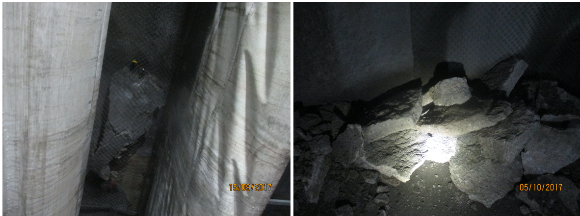
Abbildung 4.29: Abplatzungen der Spritzbetonschale des Erkundungsstollens (Fotos: Christoph Willegger).
