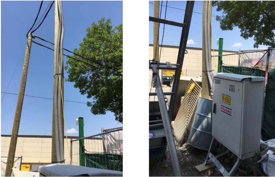
Abbildung 3-5 - Stromversorgung auf der Baustelle – BVH1 123
