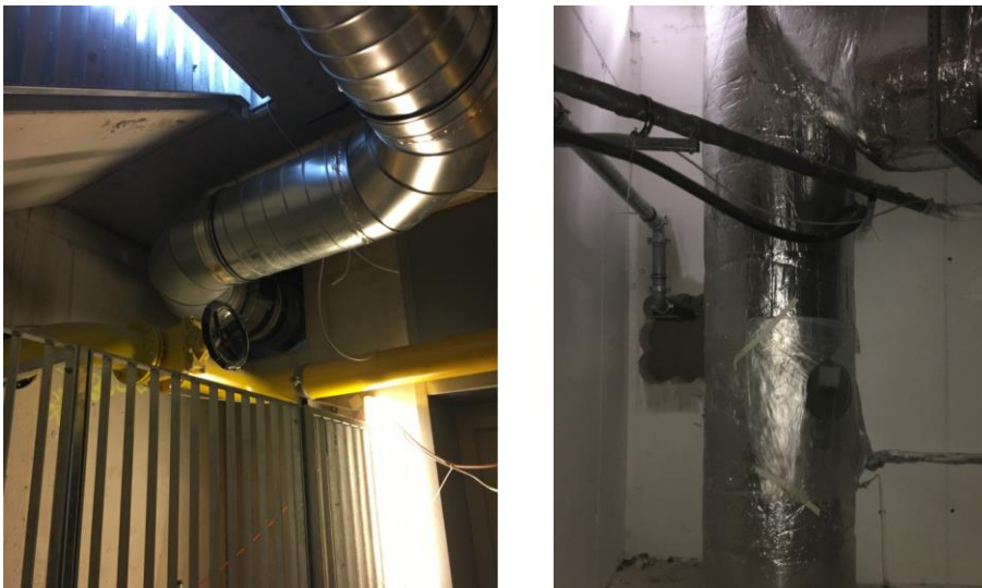
Abbildung 3-13 - Gasleitung (gelb) sowie Abluftrohr des Heizkraftwerkes – BVH3 134
