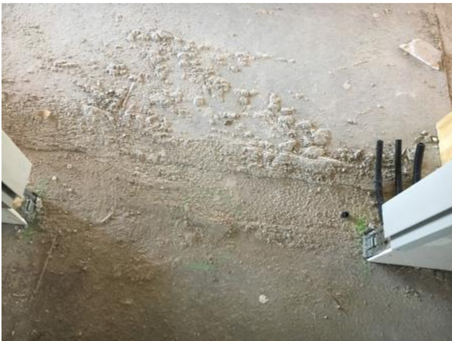
Abbildung 3-18 - Unsaubere Verfugung der Deckenelemente – BVH5 140
