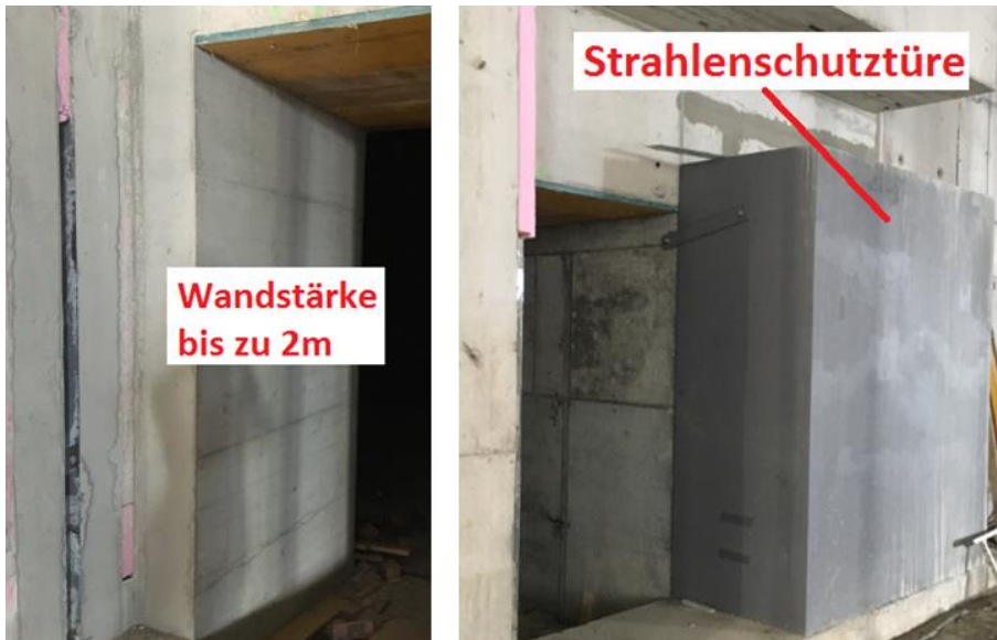
Abbildung 3-55 - Wandstärke und Strahlenschutztüre der Bestrahlungsräume-BVH18 204
