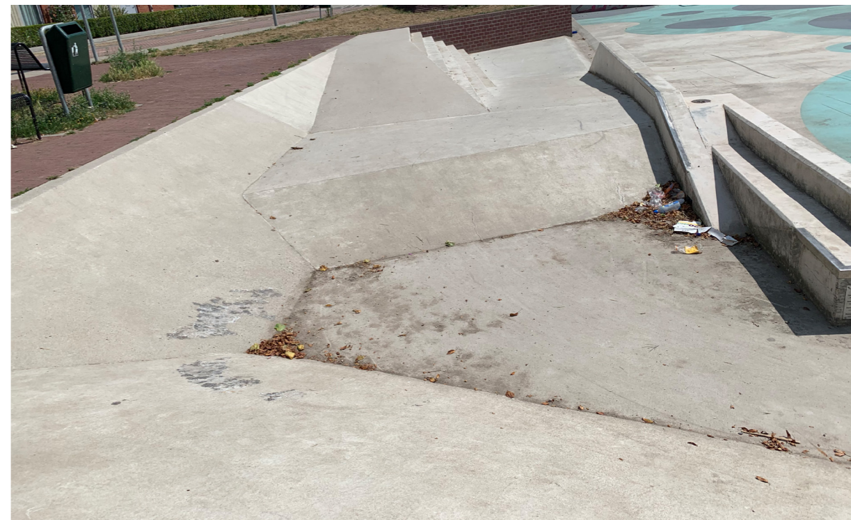
Abb. 45. Waterplein in Tiel Problemzonen
