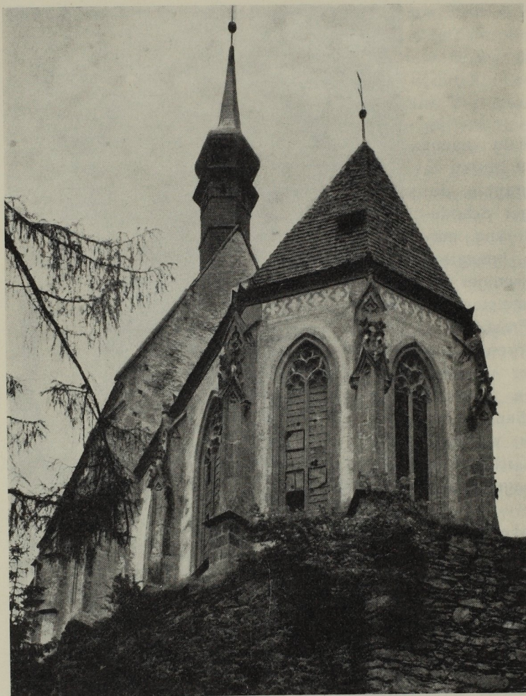
Abb. 238. Restaurierungsbedürftiges Wallfahrtskirchlein St. Leonhard.
