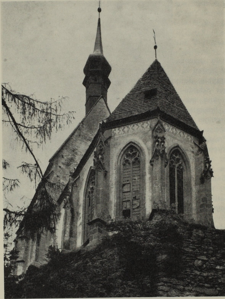
Abb. 238. Restaurierungsbedürftiges Wallfahrtskirchlein St. Leonhard.
