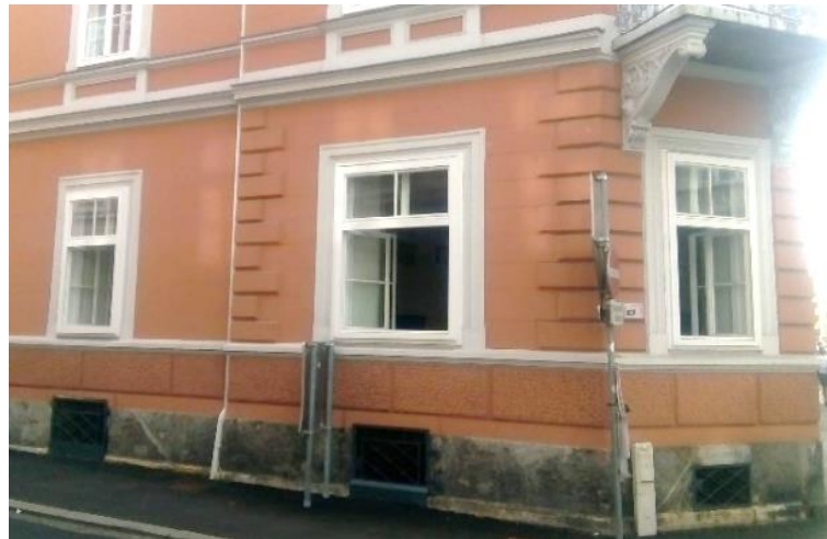
Abb. 31: Fensterlüftung in Realität
