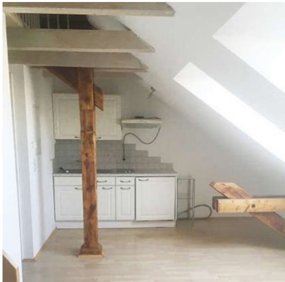
Bild 6.1 Beispiel für schlechte Integration des Vollgespärres, sowie unzulässiger Eingriff in die Dachstuhlstatik 93
