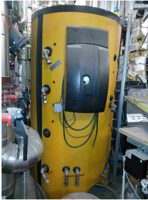
Abbildung 4.9: Foto des untersuchten Pufferspeichers (Versuchsanlage des Kompetenzzentrums Bioenergy2020+ , 1.500l)
