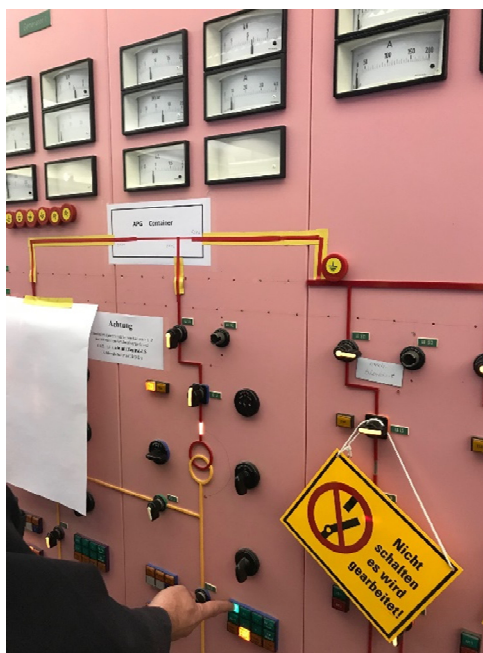
Abbildung 4.4 Schalttafel im Kraftwerk Rosenau
