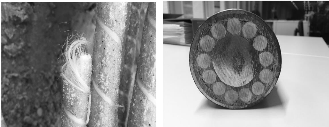
Abb. 15: links: gerissener GFK Stab, rechts: Detail des Übergangsbereichs (Buchacher, Gutsche, 2017)
