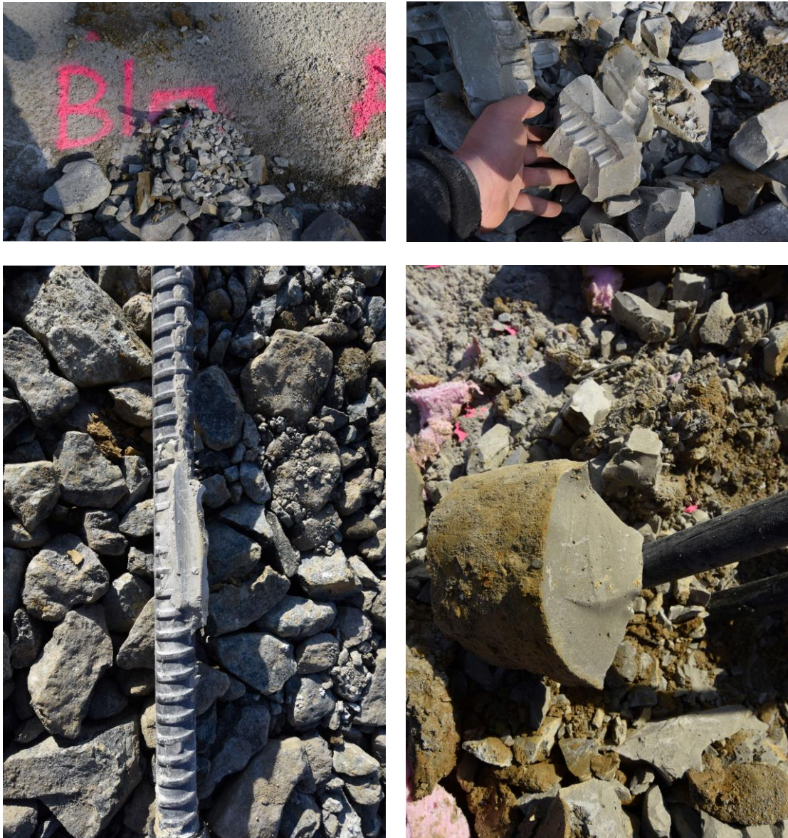
Abb. 37: o.l.: Zementsteinhaufen im Ankerkopfbereich, o.r.: Bruchstück des Zementsteins, u.l.: Detailansicht Stabanker, u.r.: Bruchstück des Zementsteins bohrwandseitig
