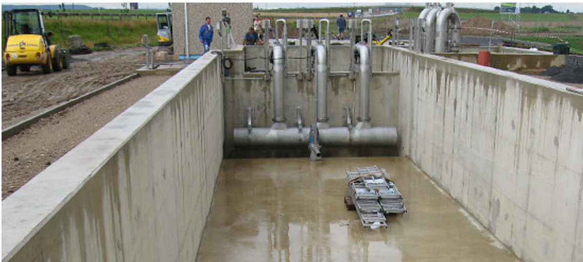
Abbildung 4-23: Regenklärbecken Schwefelberg in Pulheim (Scheel, 2020)
