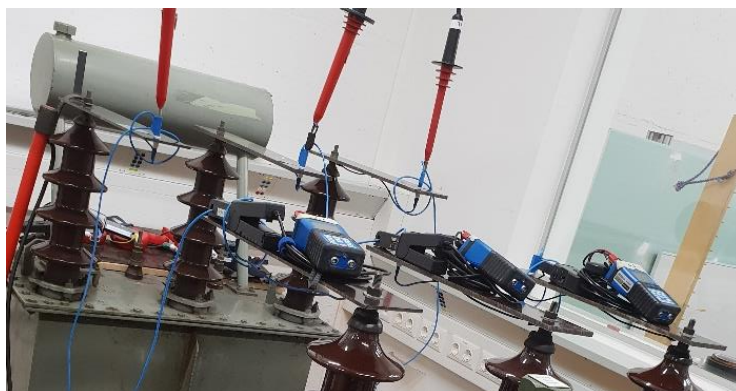
Abbildung 8-5: Strommessung auf der Hochspannungsseite
