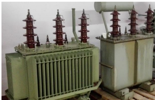
Abbildung 4-1: Transformatoren, an den die Messungen durchgeführt werden
