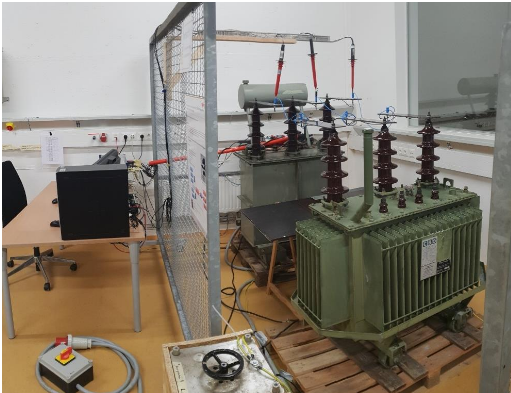
Abbildung 4-3: Messaufbau Back-to-Back Schaltung im Labor
