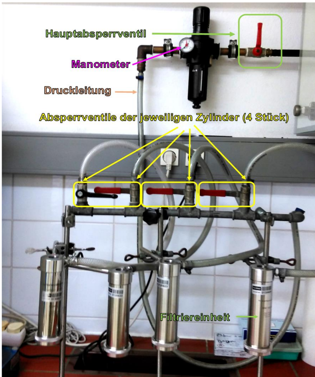
Abbildung 4-6: Die vier Druckfiltrationszylinder, das Hauptabsperrventil und vier Sperrventile der jeweiligen Zylinder im Labor des Instituts.
