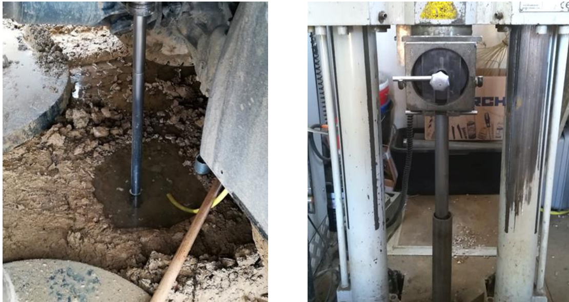
Abbildung 15: Drucksondierung mit Wasserspülung (links) und Drucksondierung mit Verrohrung (rechts) (Apparaturen von Premstaller Geotechnik ZT-GmbH)
