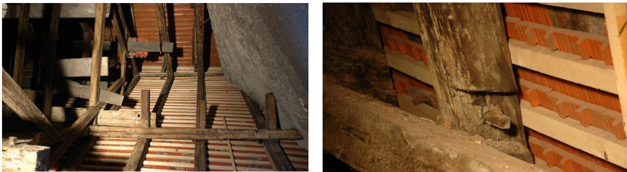
Abbildung 3.15 links: Bick zum First – zahlreiche Kehlbalken wurden ersatzlos gekappt, rechts: fehlender Kehlbalken.
