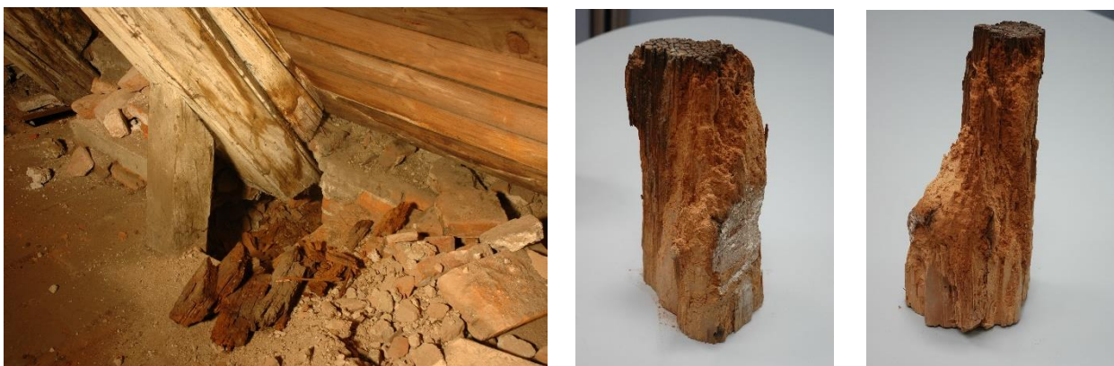
Abbildung 3.47 links: zerstörter Sparrenfußpunkt, rechts: zerstörte Dippelbaumköpfe
