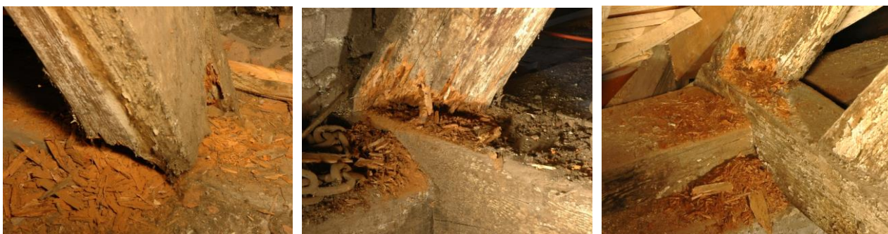
Abbildung 3.36 Geschädigte Fußpunkte in unterschiedlichen Hauptgespärren.
