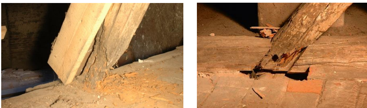
Abbildung 3.16 Schädigung von Verbindungen und Sparrenfußpunkten infolge von Pilzbefall.
