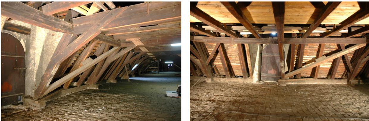
Abbildung 3.22 links: Hauptgespärre (HG) 11, Fußpunkt ohne geschmiedeter Klammer, rechts: Verformung des Rähms zwischen HG 10 und HG 12.
