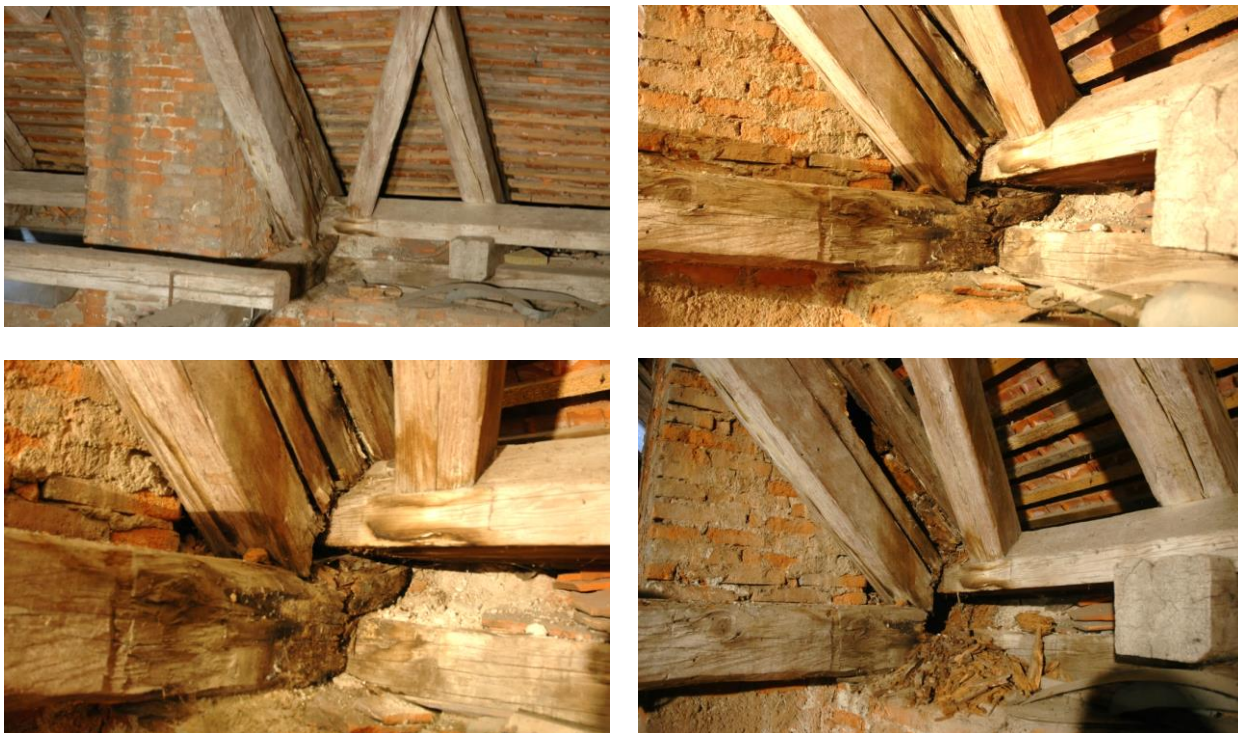
Abbildung 3.33 Infolge Pilzbefall geschädigter Stuhlsäulenfußpunkt
