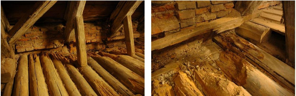
Abbildung 3.48 zerstörter Auflagerbereich der Dippelbaumdecke.
