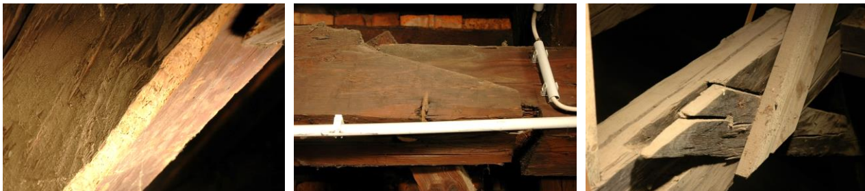
Abbildung 3.24 links: abgeklunger Nagekäferbefall, mitte/rechts: klaffende Verbindungen.
