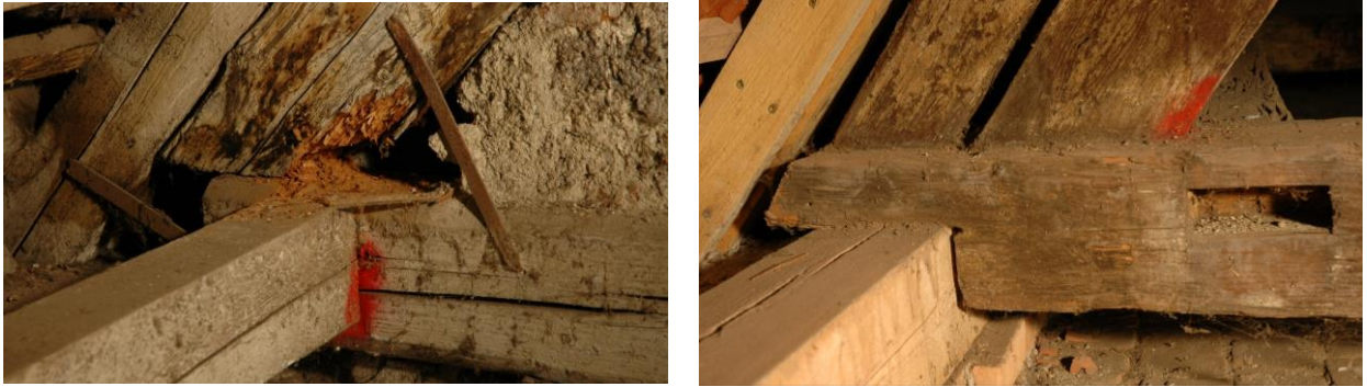
Abbildung 3.26 links: Stuhlsäulenfußpunkt von Hauptgespärre 3 rechts: instandgesetzter und geschädigter Stuhlsäulenfußpunkt von HG 1.
