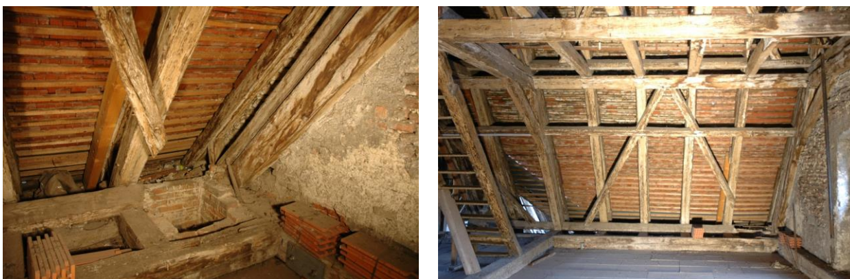
Abbildung 3.29 Kappung von Bauteilen infolge des Einbaus von Kaminen
