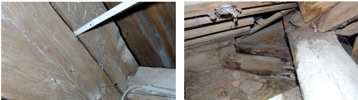
Abbildung 3.52 links: Riss in Stuhlsäule, Rechts: Feuchteschaden im Ichsengesparre mit Pilzbefall
