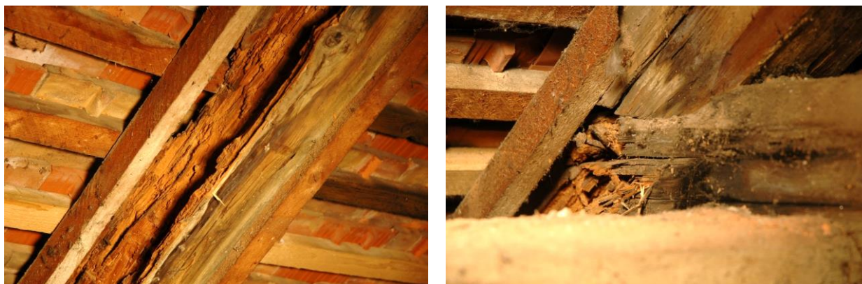
Abbildung 3.13 links: geschädigter Sparren durch Pilzbefall, rechts: geschädigte Sparren-Kehlbalken-Verbindung
