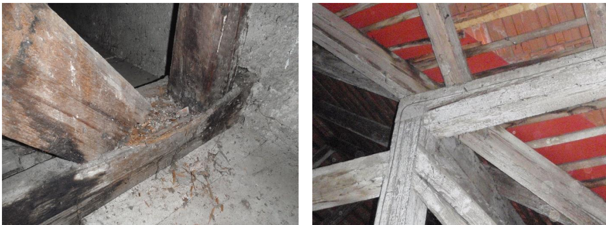
Abbildung 3.61 links: Pilzbefall Sterbenfußpunkt, rechts: Querrzugriss bei Ausklinkung
