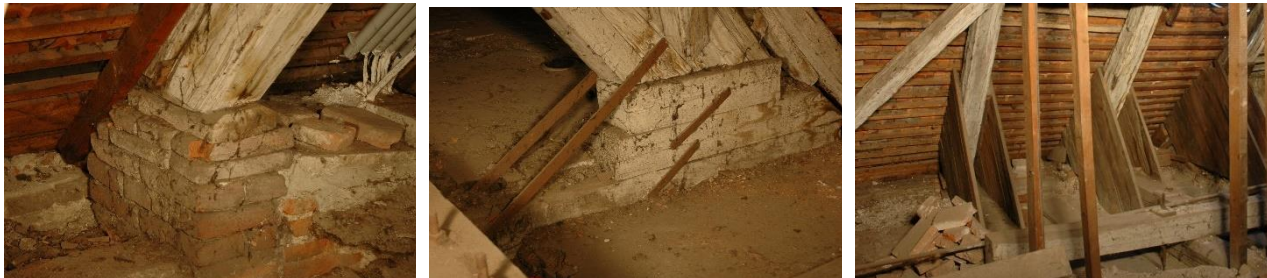
Abbildung 3.45 nicht fachgemäß instandgesetzte Stuhlsäulenfußpunkte
