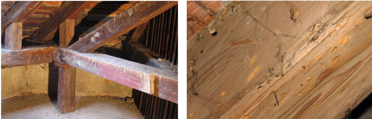
Abbildung 3.58 links: Verstärkungen im Bereich der Südecke, rechts: Hausbockbefall am Sparren 16'. [29]
