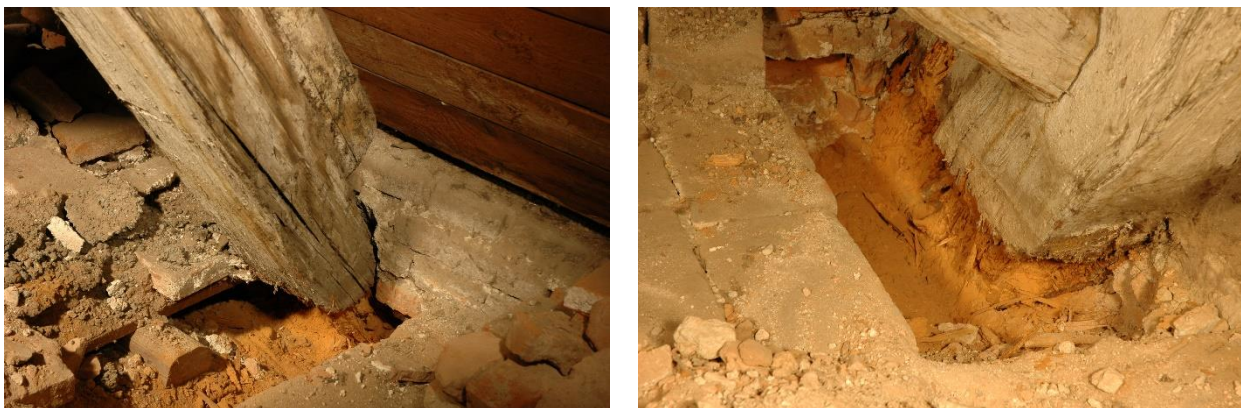
Abbildung 3.46 Zerstörte Sparrenfußpunkte infolge Pilzbefall
