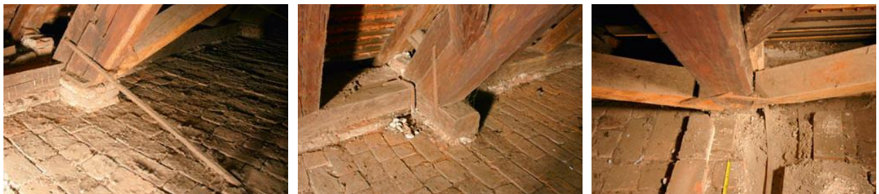
Abbildung 3.21 Unfachgemäße Instandsetzung der Stuhlsäulenfußpunkte.
