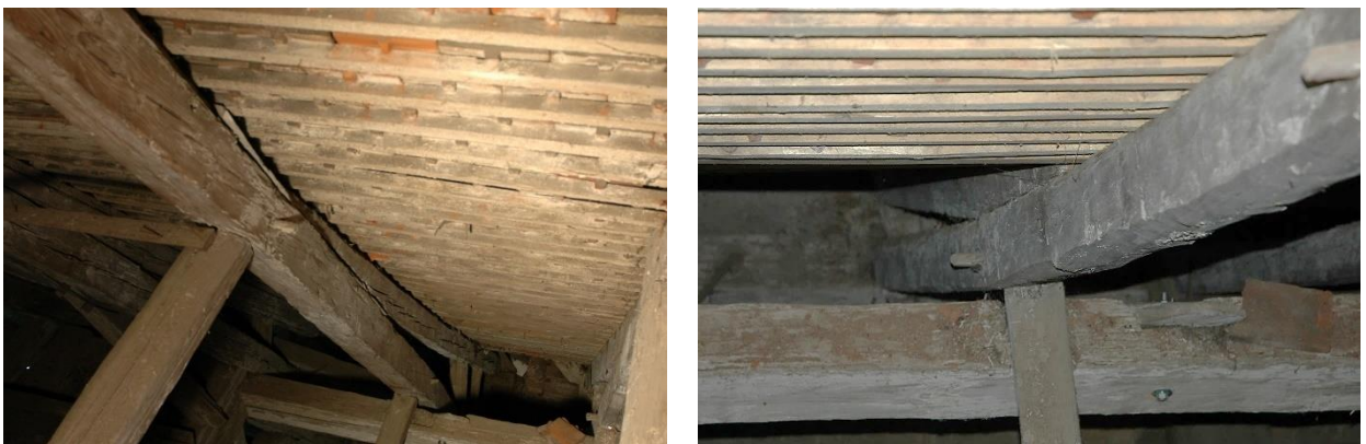
Abbildung 3.18 Durchhang der nordseitigen Sparren
