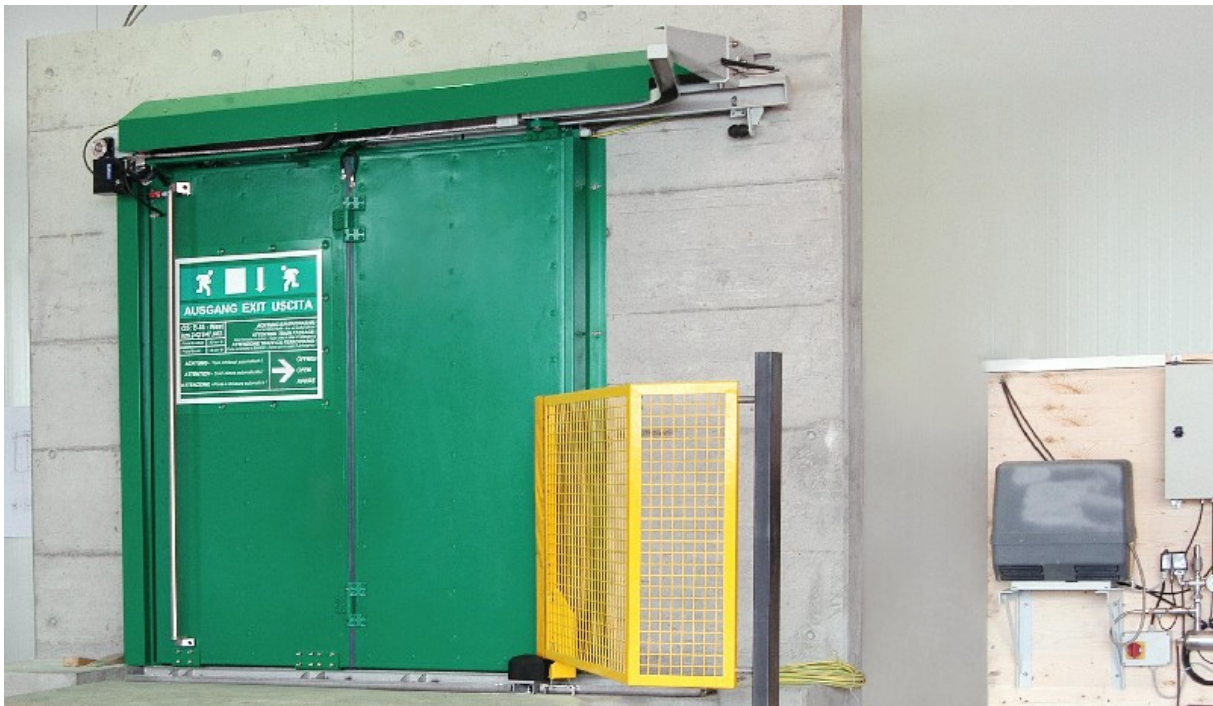
Abb. 29: Gotthard-Basistunnel (CH) – Querschlagtüre geschlossen (Systemdarstellung)
