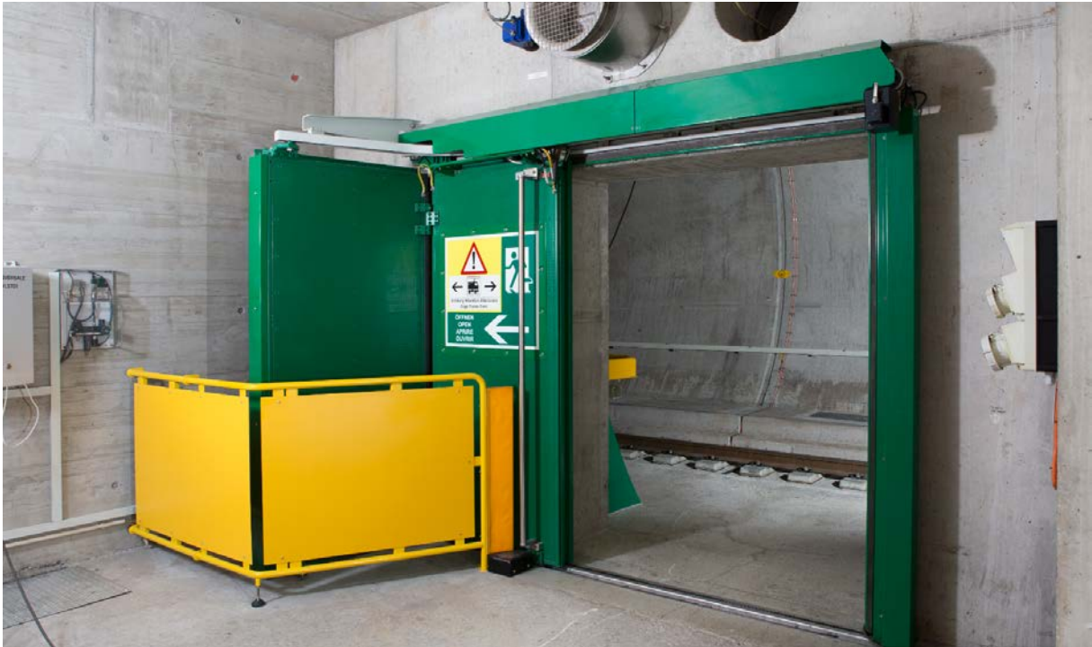
Abb. 30: Gotthard-Basistunnel (CH) – Querschlagtüre geöffnet
