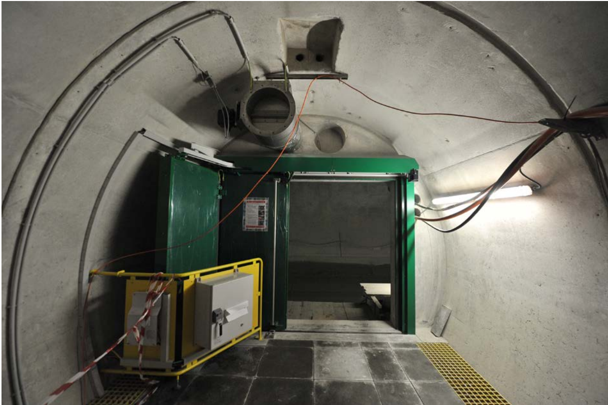
Abb. 31: Ceneri-Basistunnel (CH) – Querschlagtüre
