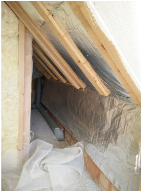
Abbildung 3.2: unausgebauter Teilbereich im Dachboden
