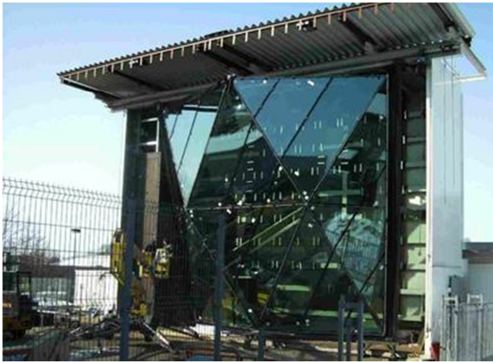
Bild 3.5 Fassadenprüfstand von Dobler Metallbau 136
