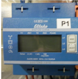
Abbildung A. 5- 1: Energiezähler der Wärmepumpeneinheit
