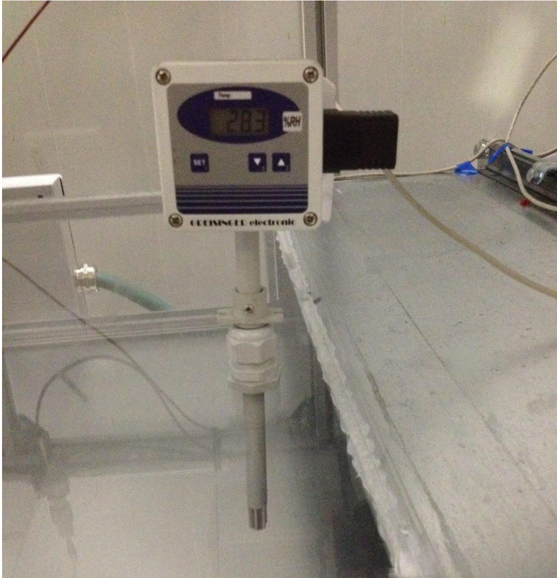
Abbildung 4-44 - Hygrometer im eingebauten Zustand, IRWT
