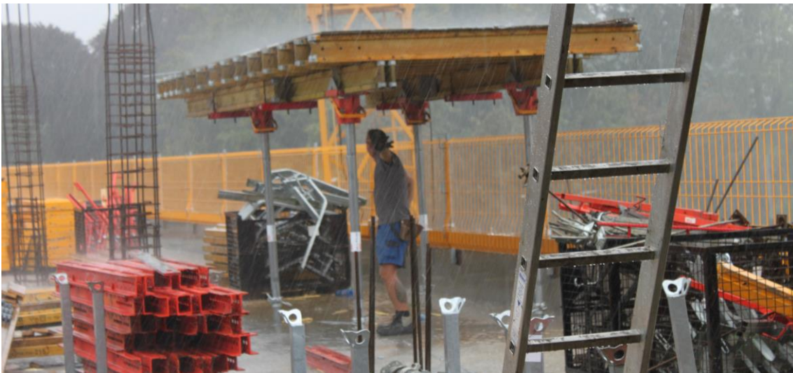
Abbildung 3-16: MS - Unterbrechung aufgrund starken Regens
