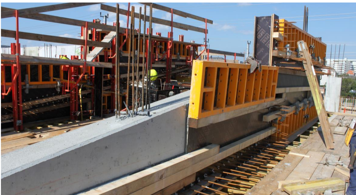
Abbildung 5-128: Teilweise ausgeschalter Rampenträger auf Stützen (17.09.2014)
