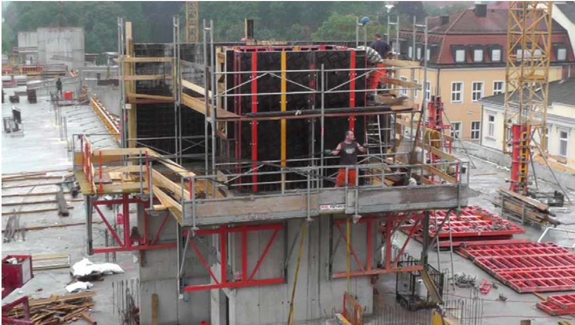
Abbildung 6-13: Beengte Arbeits- und Lagerverhältnisse bei den Bewehrungsarbeiten beim Stiegenhaus: Kern mit T-Stück (17.09.2014)
