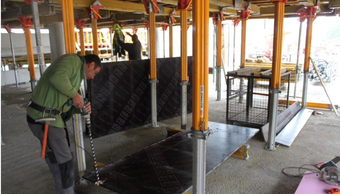
Abbildung 5-43: Bohren der Löcher für die Anschlussbewehrung im darunterliegenden Geschoß aufgrund des starken Regens (02.09.2014)
