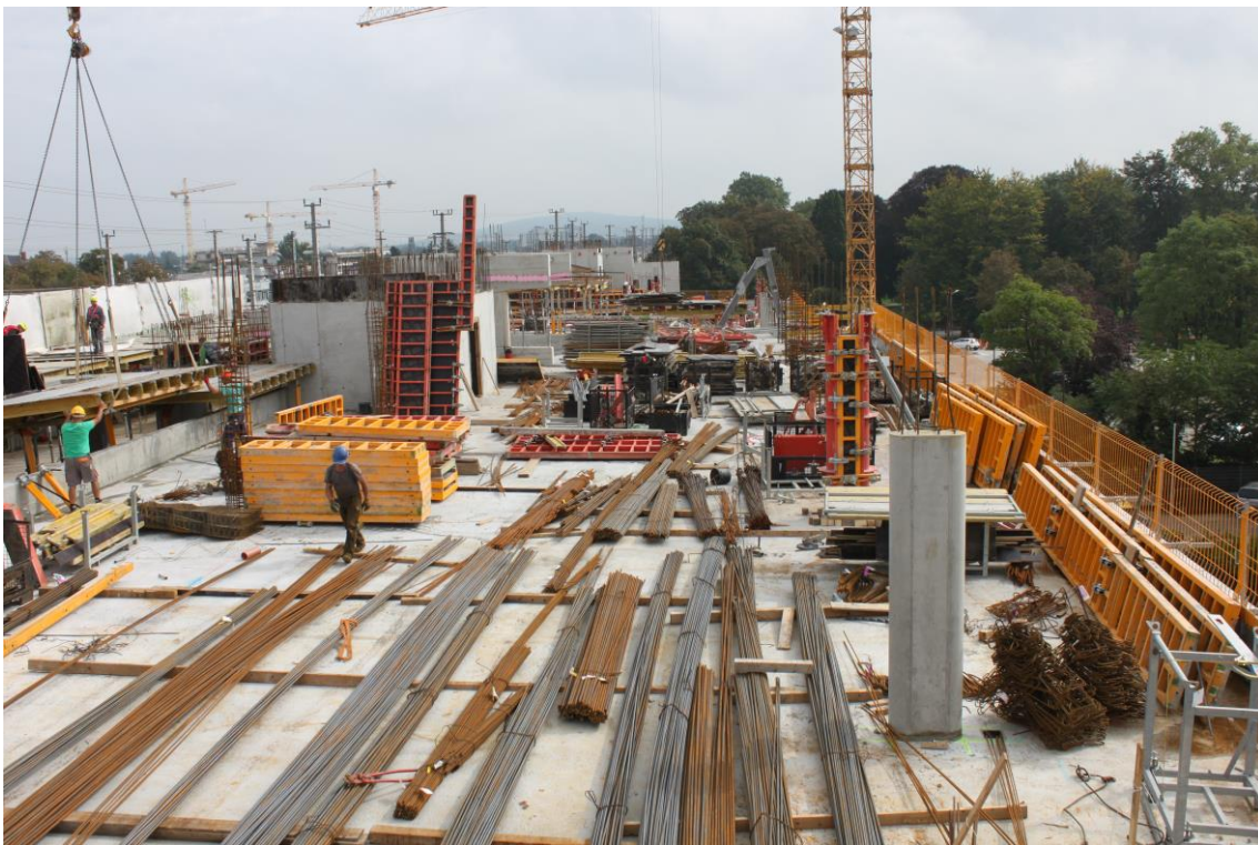
Abbildung 7-1: Sehr beengte Lagerverhältnisse auf der Baustelle
