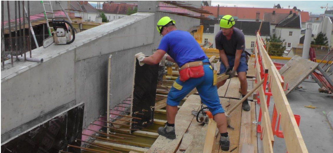
Abbildung 7-4: Ausschalen durchbohrter Schaltafeln, die zerschnitten werden mussten
