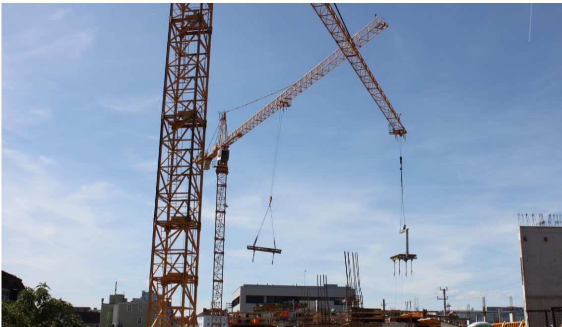
Abbildung 4-10: Transport der Deckenschaltische vom Ost- in den Westbereich des Parkdecks durch die Krane
