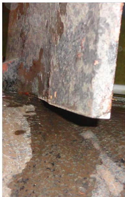
Abbildung 2-4 Leitschaufelüberstand im KW Annabrücke, maximale Öffnung 60°
